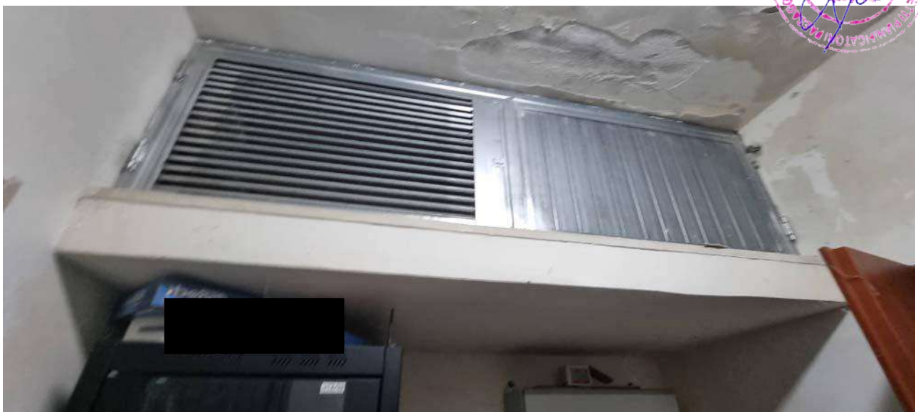
Foto 20: Armadietto impianti nella zona impianti tecnici antistante i servizi igienici
