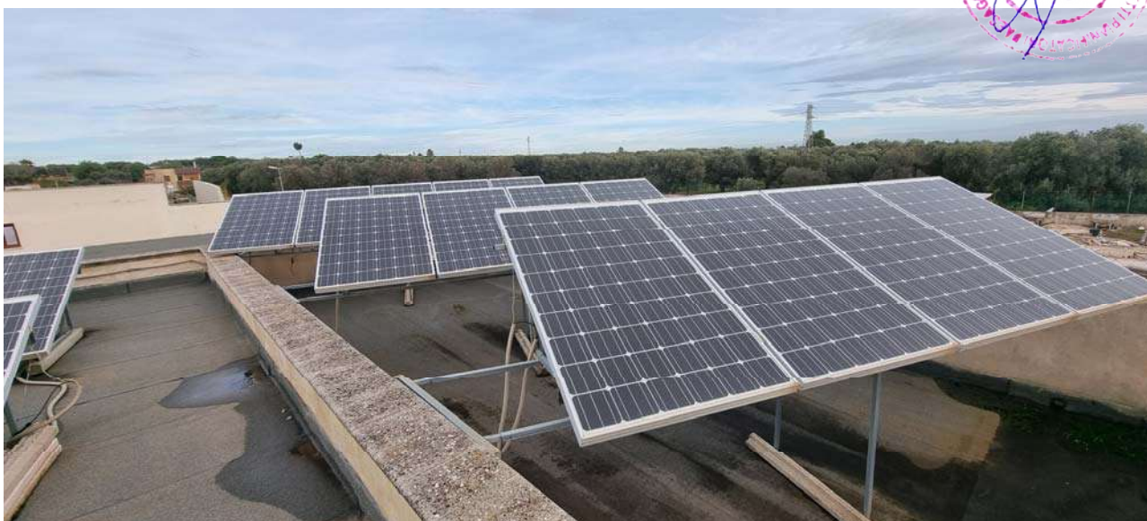
Foto 39: Pannelli dell’impianto fotovoltaico in angolo SUD-EST
