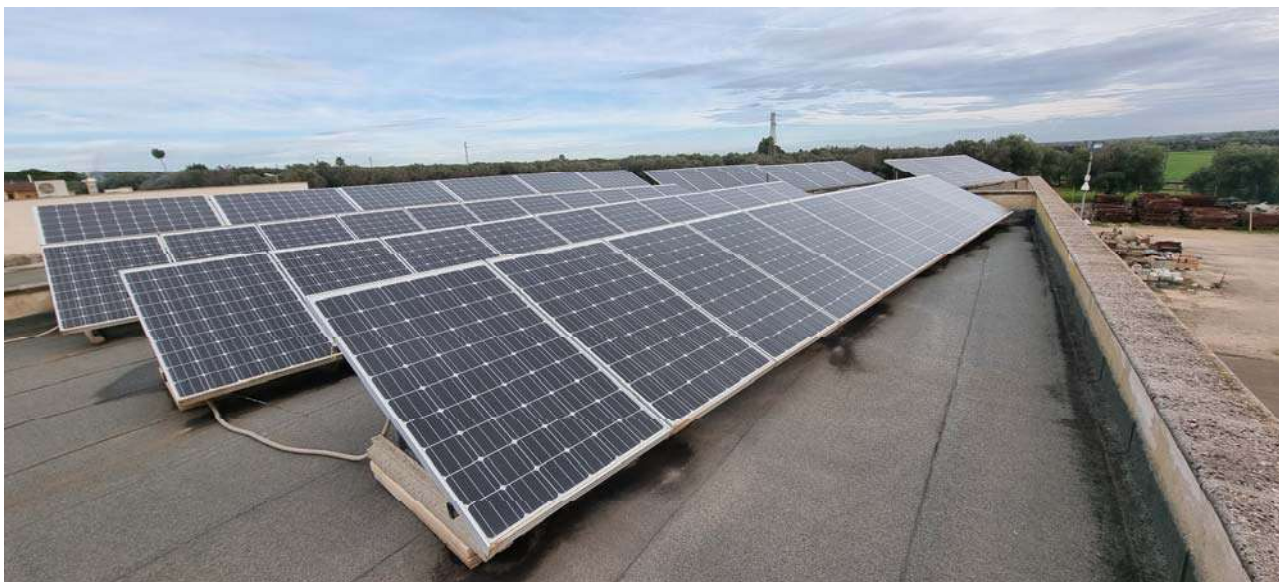
Foto 37 – Pannelli centrali e ad EST dell’impianto fotovoltaico sulla fascia SUD del subalterno 9
