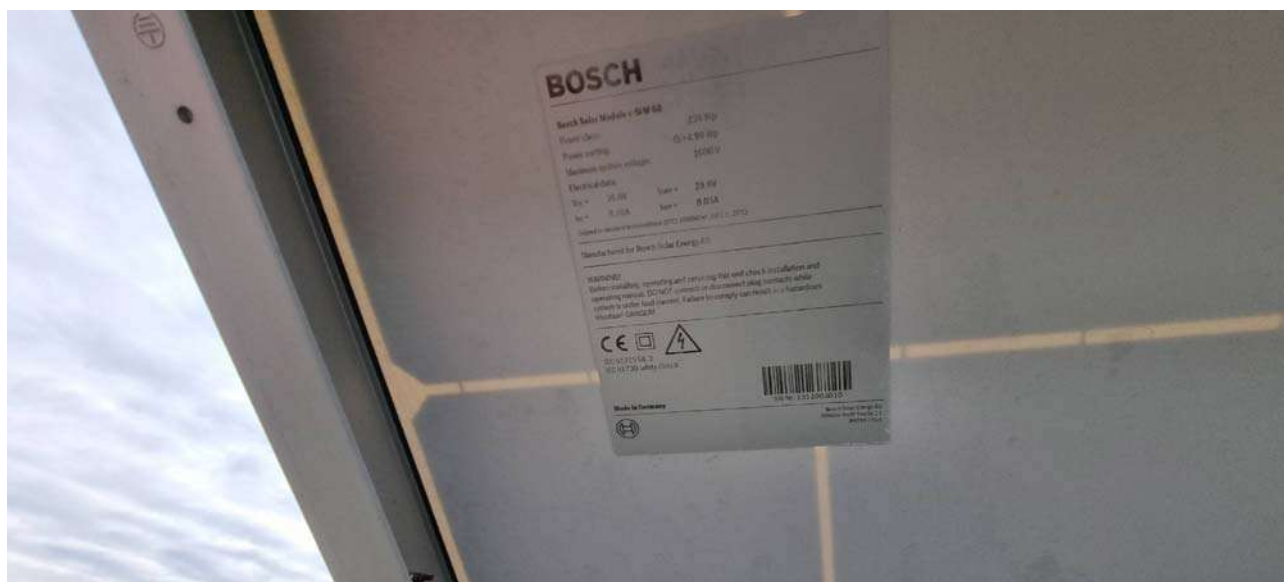
Foto 40: Etichetta di pannello fotovoltaico
