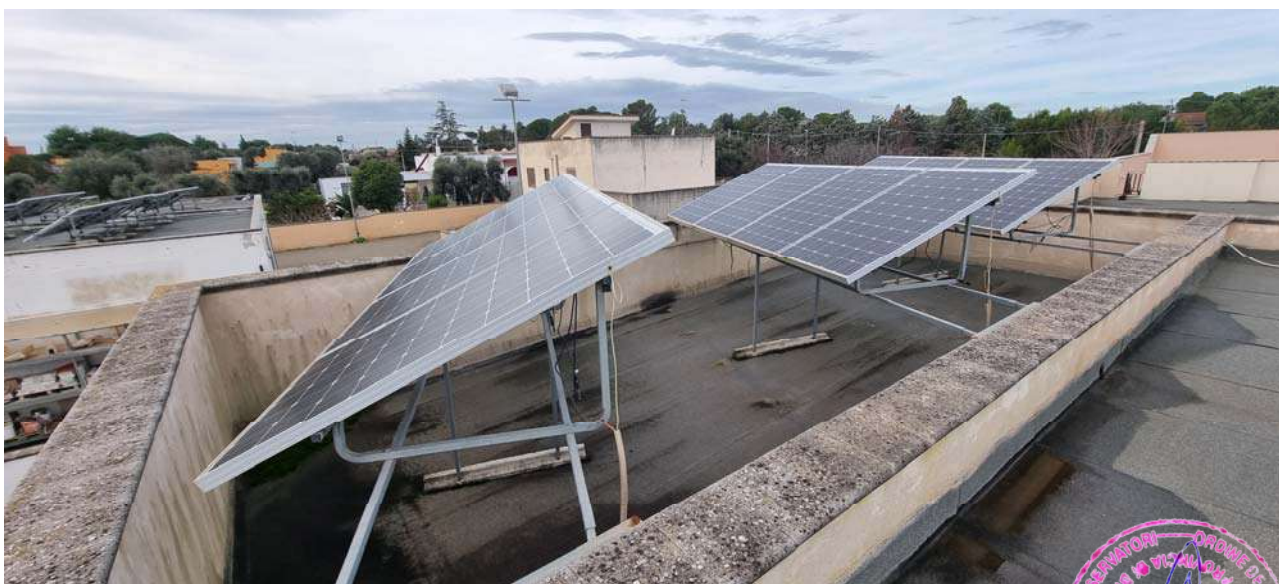
Foto 38: Porzione ad OVEST di pannelli dell’Impianto fotovoltaico
