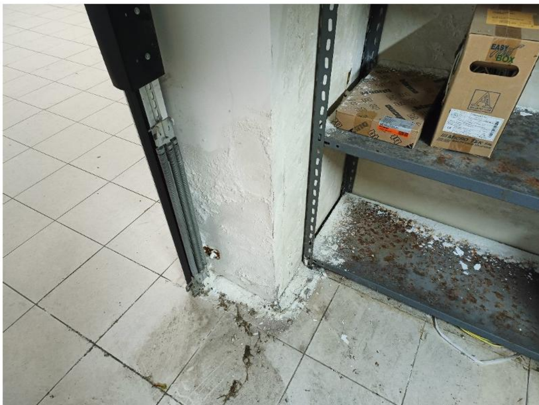
Foto 4: Particolare umidità di risalita
