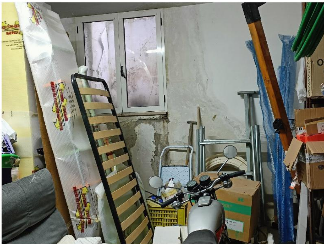
Foto 5: Particolare infiltrazione bocca di lupo
