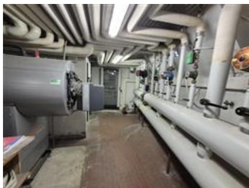
Attuale locale centrale termica ad uso comune a piano sottostrada della p.ed. 163/2 c.c. Cles di proprietà di terzi.
