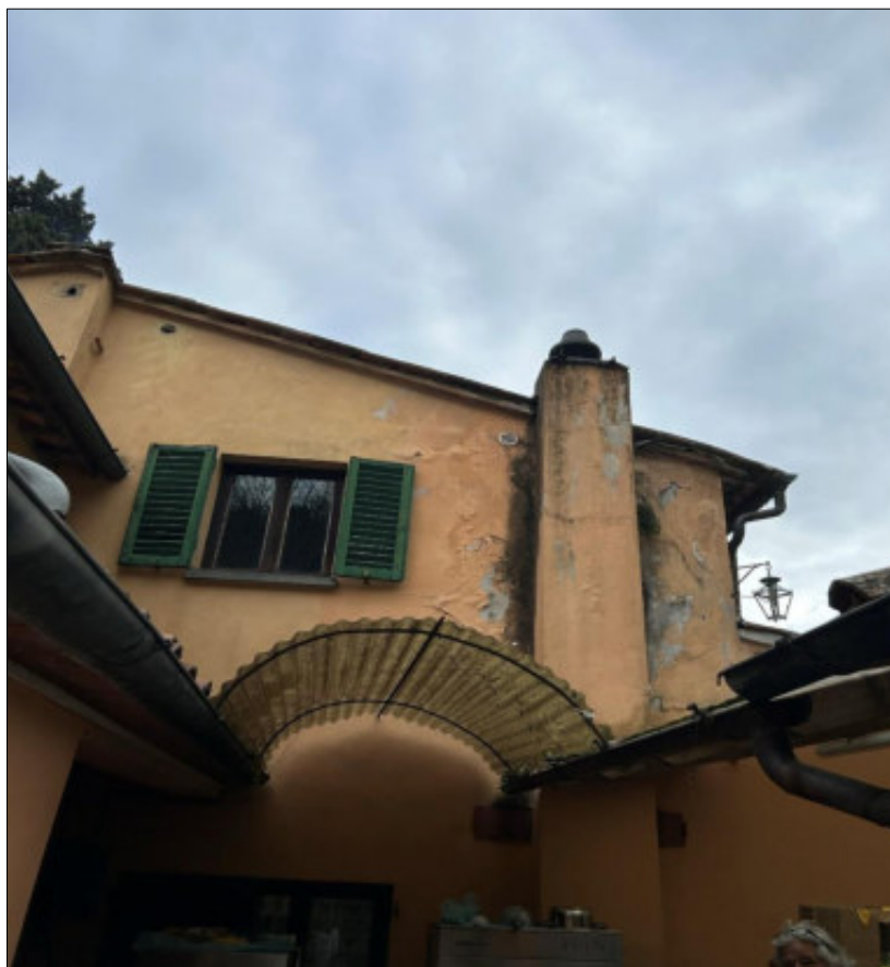
Foto 14 – particolare ammaloramenti intonaci
