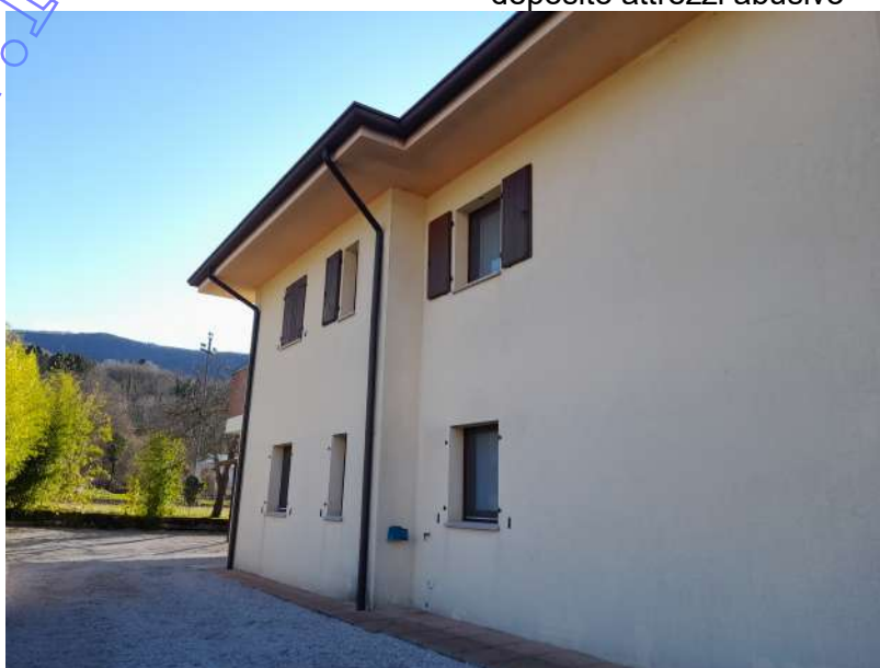
facciata laterale con deposito attrezzi abusivo
