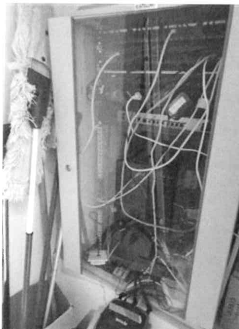
particolare vano tecnico del sub. 541 (ubicazione server)
