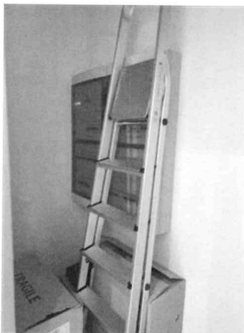
locale tecnico (quadro elettrico generale comune)
