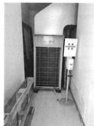
vano tecnico del sub. 540 (imp. ventilazione)
