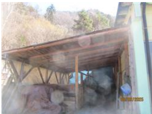
MANUFATTO NON AUTORIZZATO -PREVISTO IN DEMOLIZIONE
