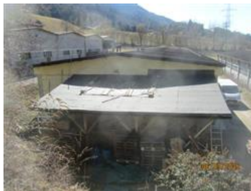
MANUFATTO NON AUTORIZZATO -PREVISTO IN DEMOLIZIONE
