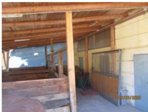
MANUFATTO NON AUTORIZZATO -PREVISTO IN DEMOLIZIONE
