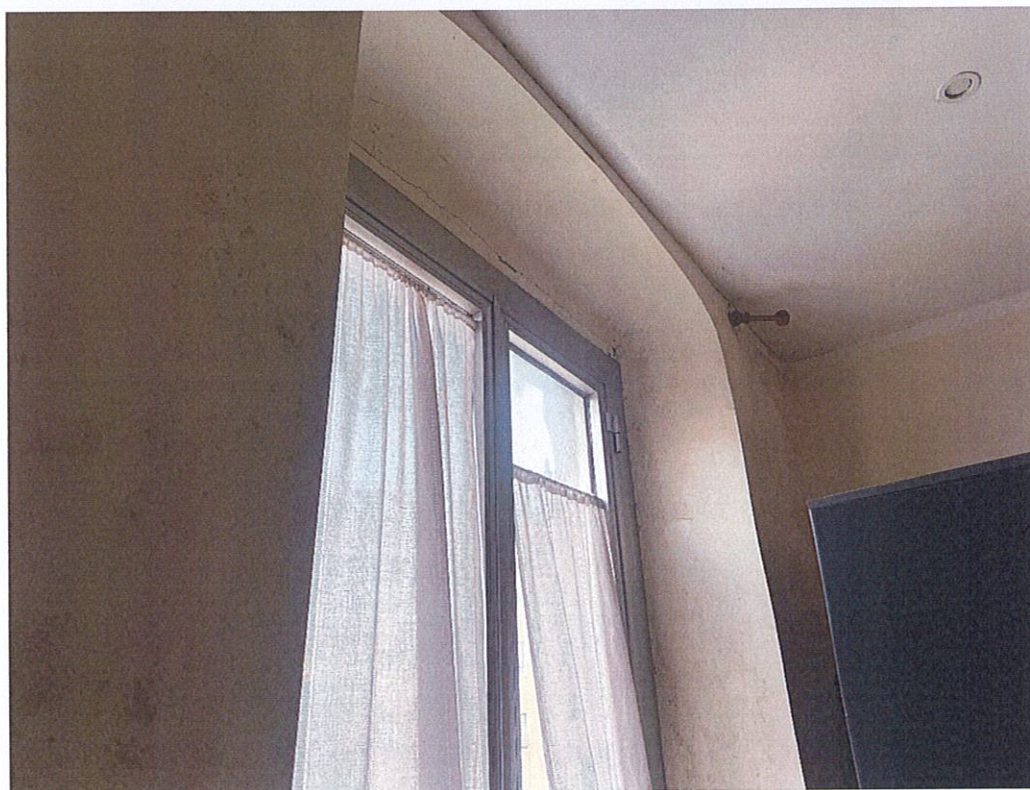
Foto 21. Particolare muffa a parete
