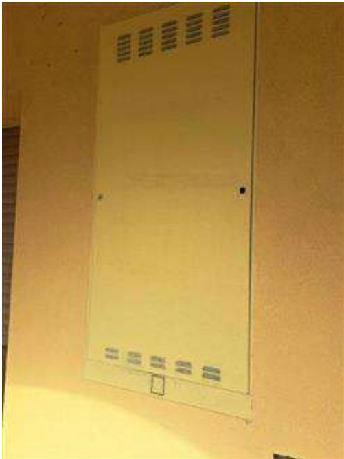
vano caldaia su terrazzo esterno coperto
