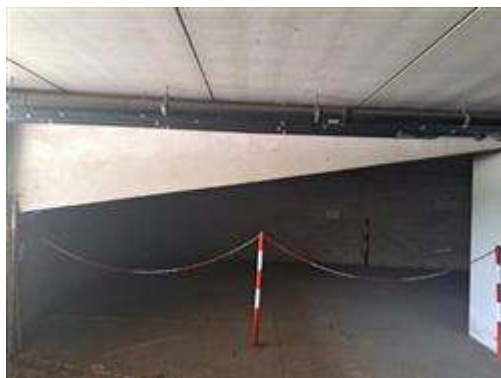
subalterni 17-18 delimitati da una barriera non oltrepassabile posiziona dopo sopralluogo dei Vigili del Fuoco
