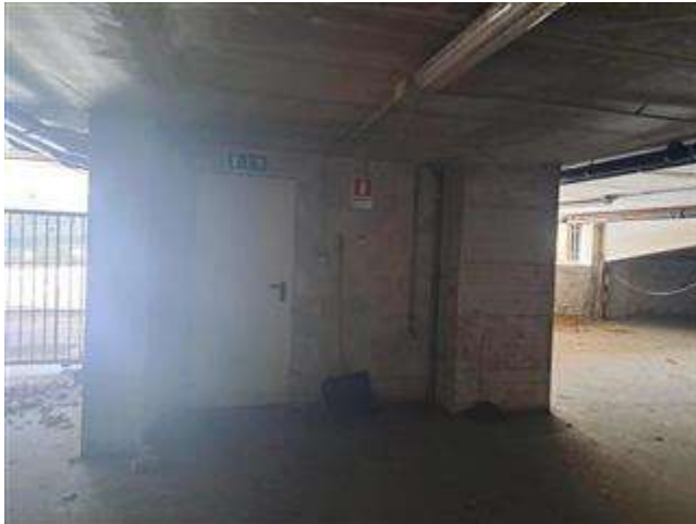
accesso alla scalinata con porta tagliafuoco
