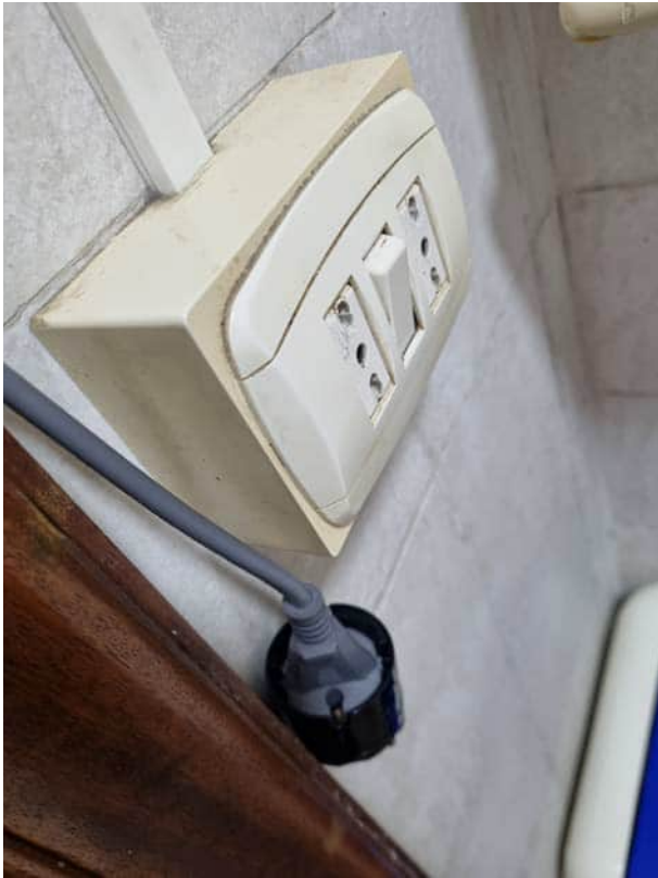
Foto 16 – Particolare impianto elettrico
