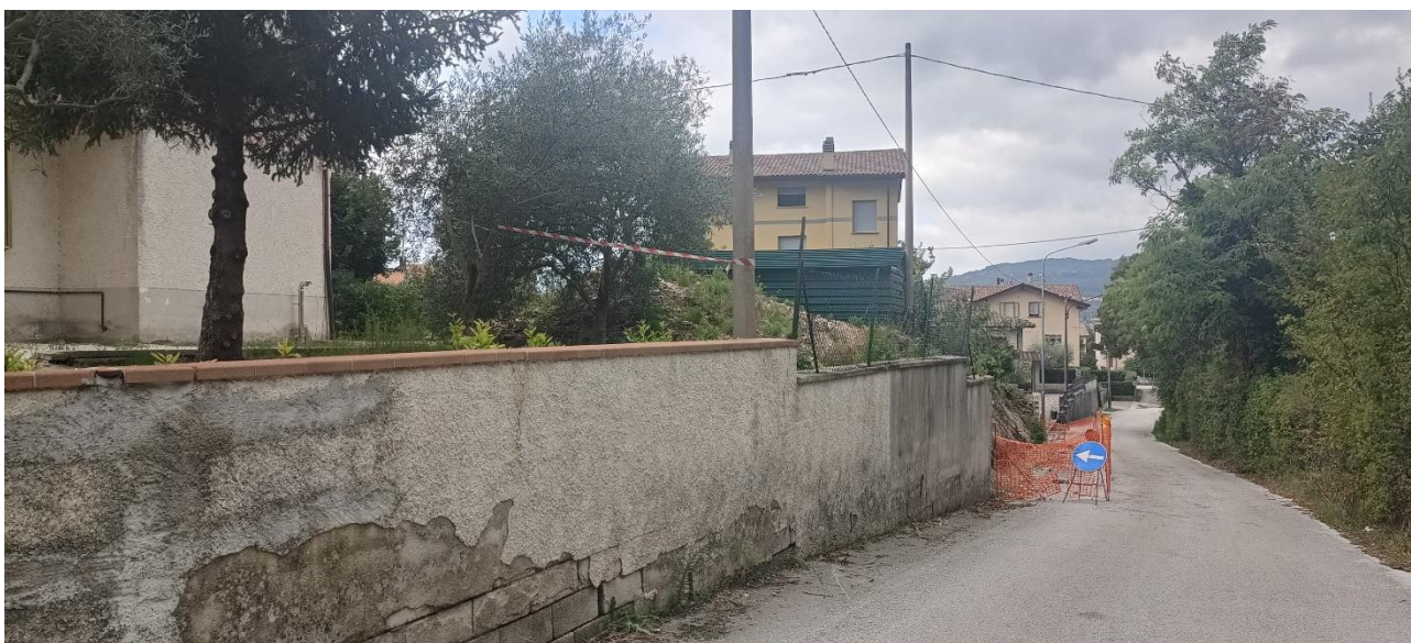
Foto n.5: veduta del muro di sostegno prospiciente la strada pubblica via Ponte delle Cartiere interessato dal cedimento con necessità di interventi di messa in sicurezza.
