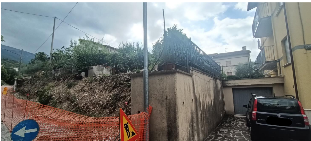
Foto n.6: altro particolare dell'area interessata dal cedimento del muro posto a delimitazione della rata di terreno identificata con la particella 2036, originata dal frazionamento dell'originaria corte comune (particella 691) e venduta con atto del 31/10/2007, non oggetto di pignoramento.
