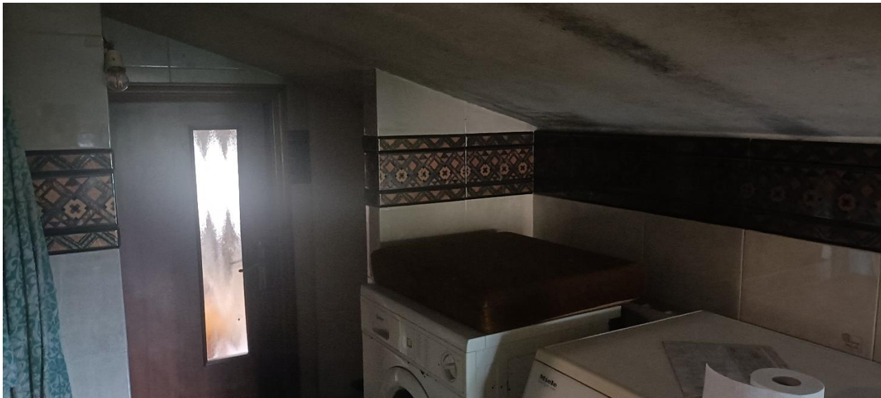
Foto n.16: particolare interno del bagno dotato di collegamento con la soffitta ad uso ripostiglio con diffuse macchie di umidità e condensa sul soffitto.
