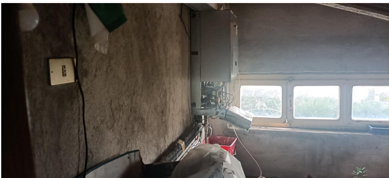
Foto n.17: particolare interno della soffitta ad uso ripostiglio dove è alloggiata la caldaia.
