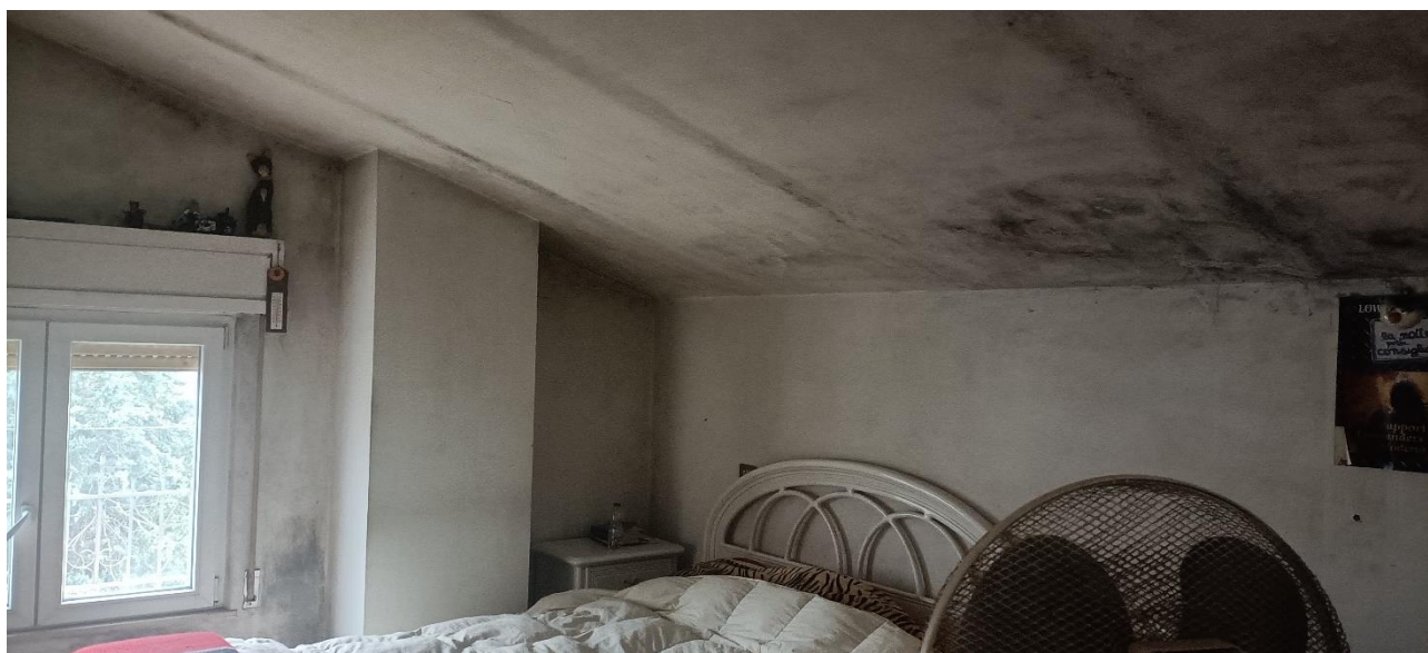
Foto n.14: particolare della seconda camera con diffuse macchie di umidità e condensa sul soffitto.
