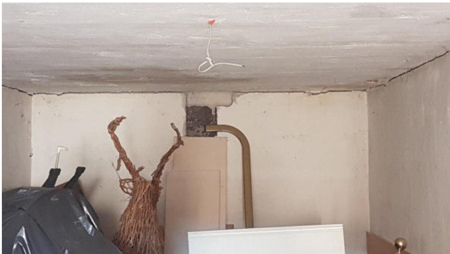
Vista della lesione perimetrale
