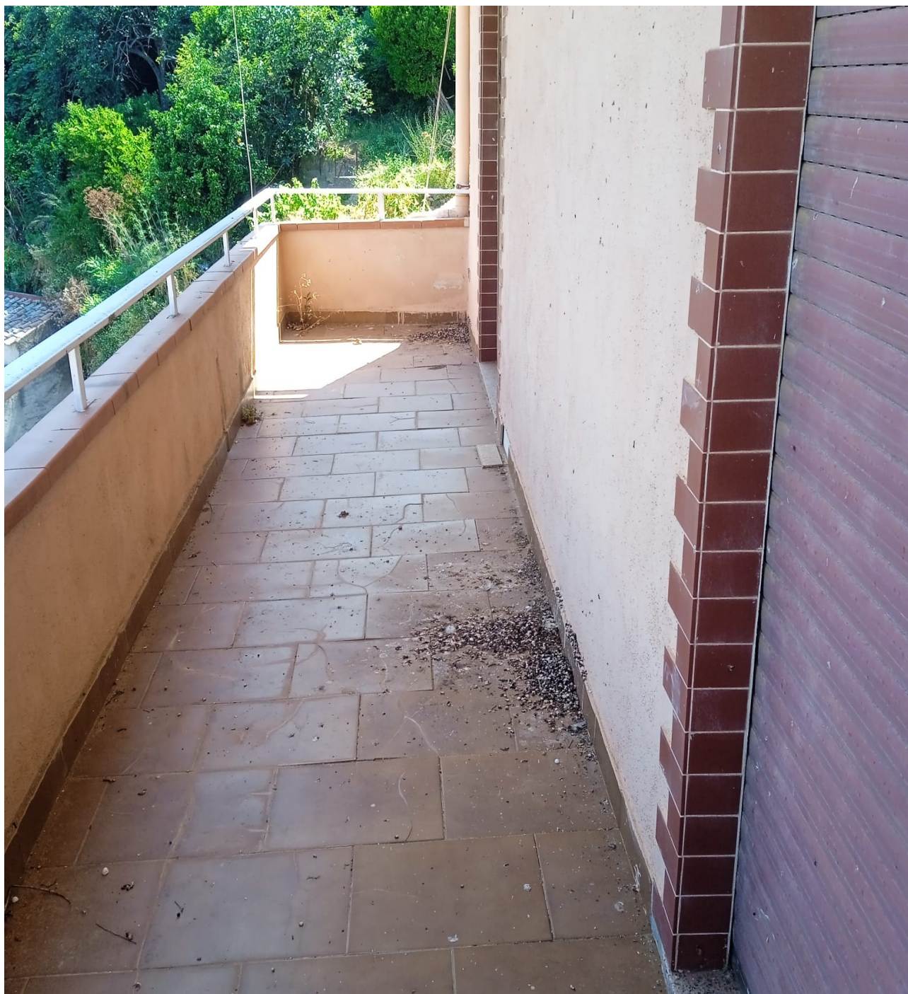
Foto n. 19 Balcone 2 piano appartamento Particella 71 sub 4
