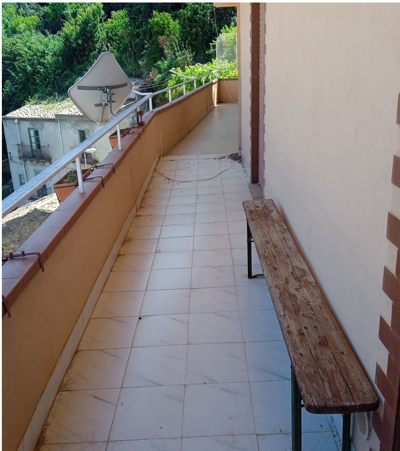
Foto n. 16 Balcone I piano appartamento Particella 73 e 71 sub 4
