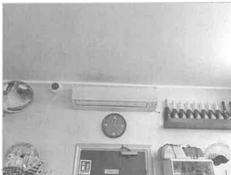
Fotografia n 12 - vista interno bar con apparecchio a parete per condizionamento
