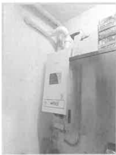
Fotografia n 11 - vista caldaia autonoma a parete
