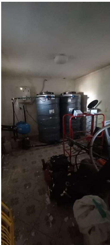
Foton.33 Vista nuova centrale idrica
