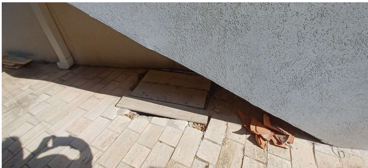
Foto n.43 Vista pozzetto pozzo disperdente reflui
