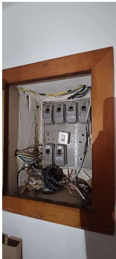
Foto n.42 Vista condizione quadro elettrico
