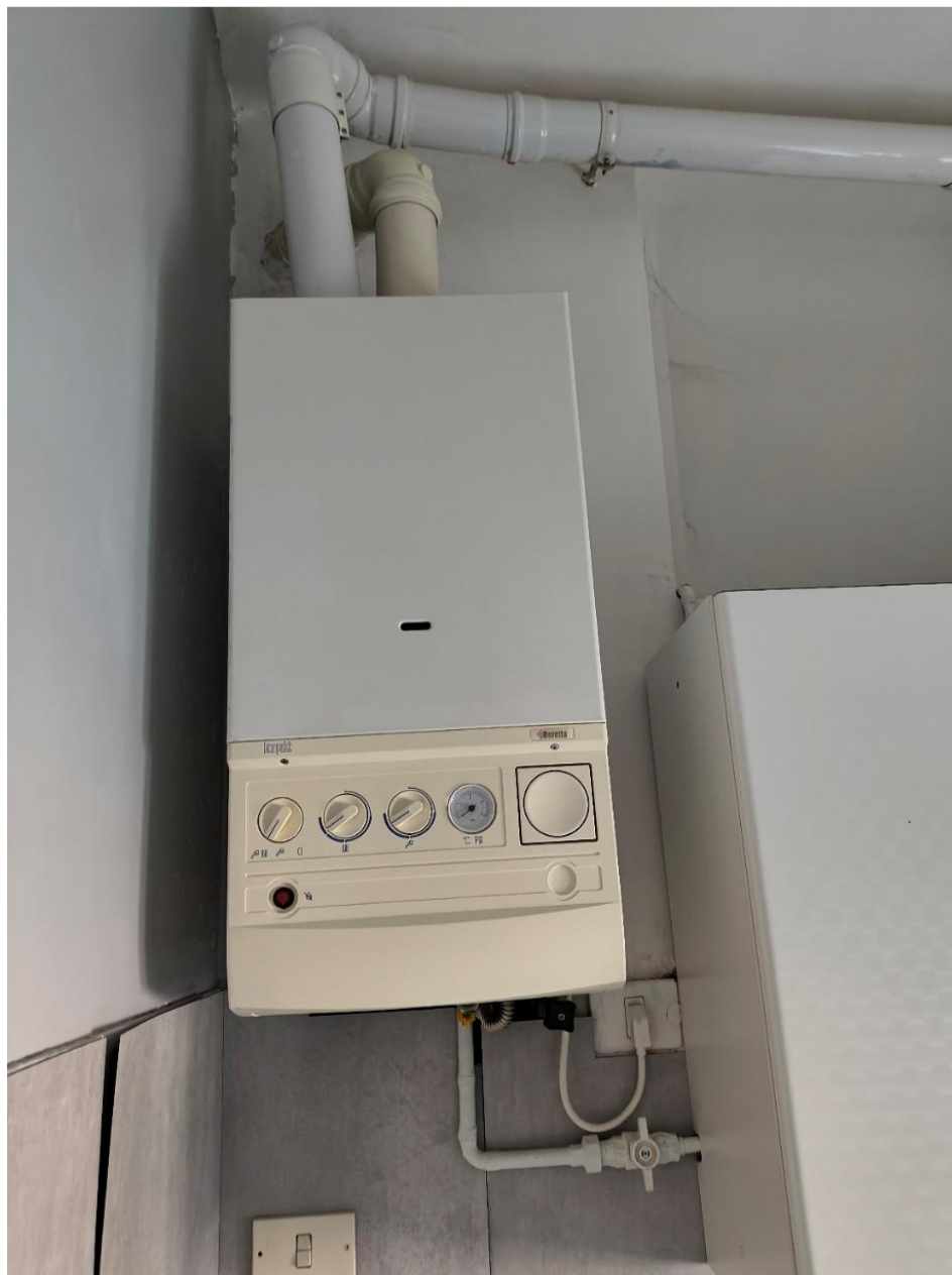
VISTA DELLA CALDAIA MURARIA IN CUCINA
