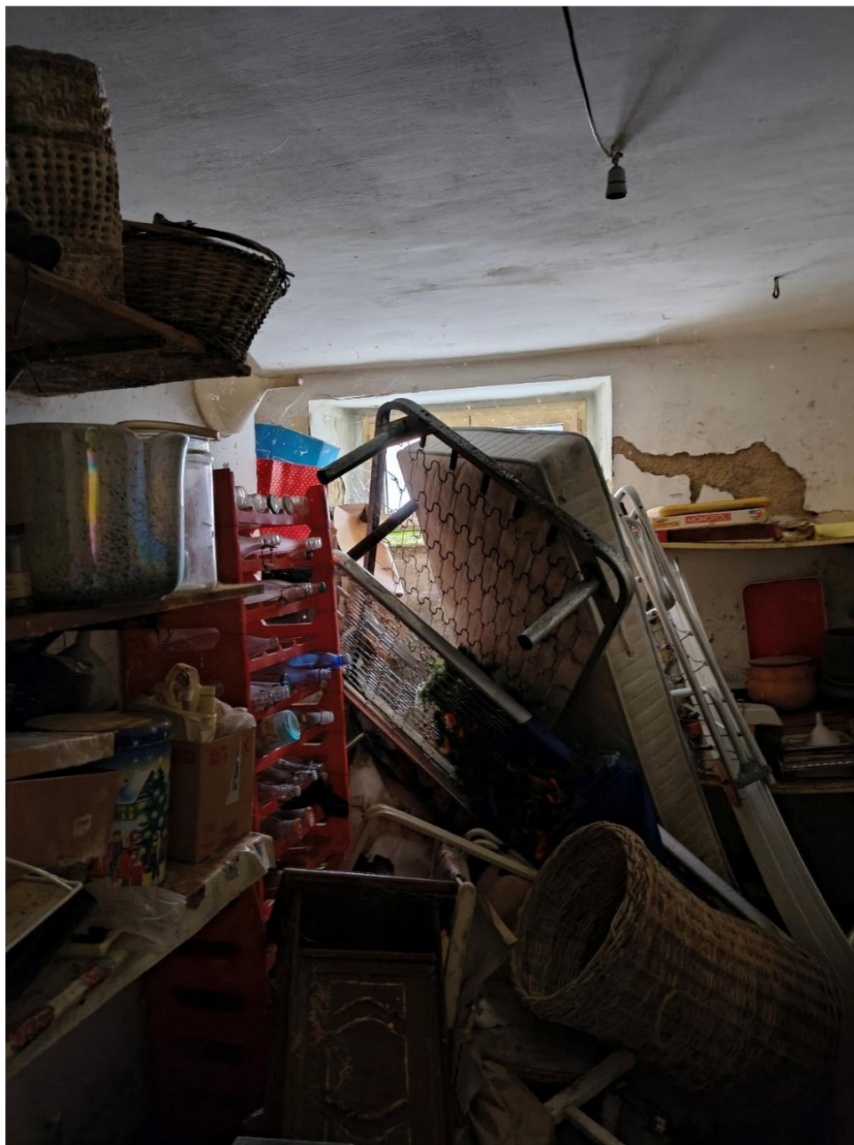
VISTA DEL FONDO, SI NOTA LA PRENZA DI LESIONI NELL'INTONACO
