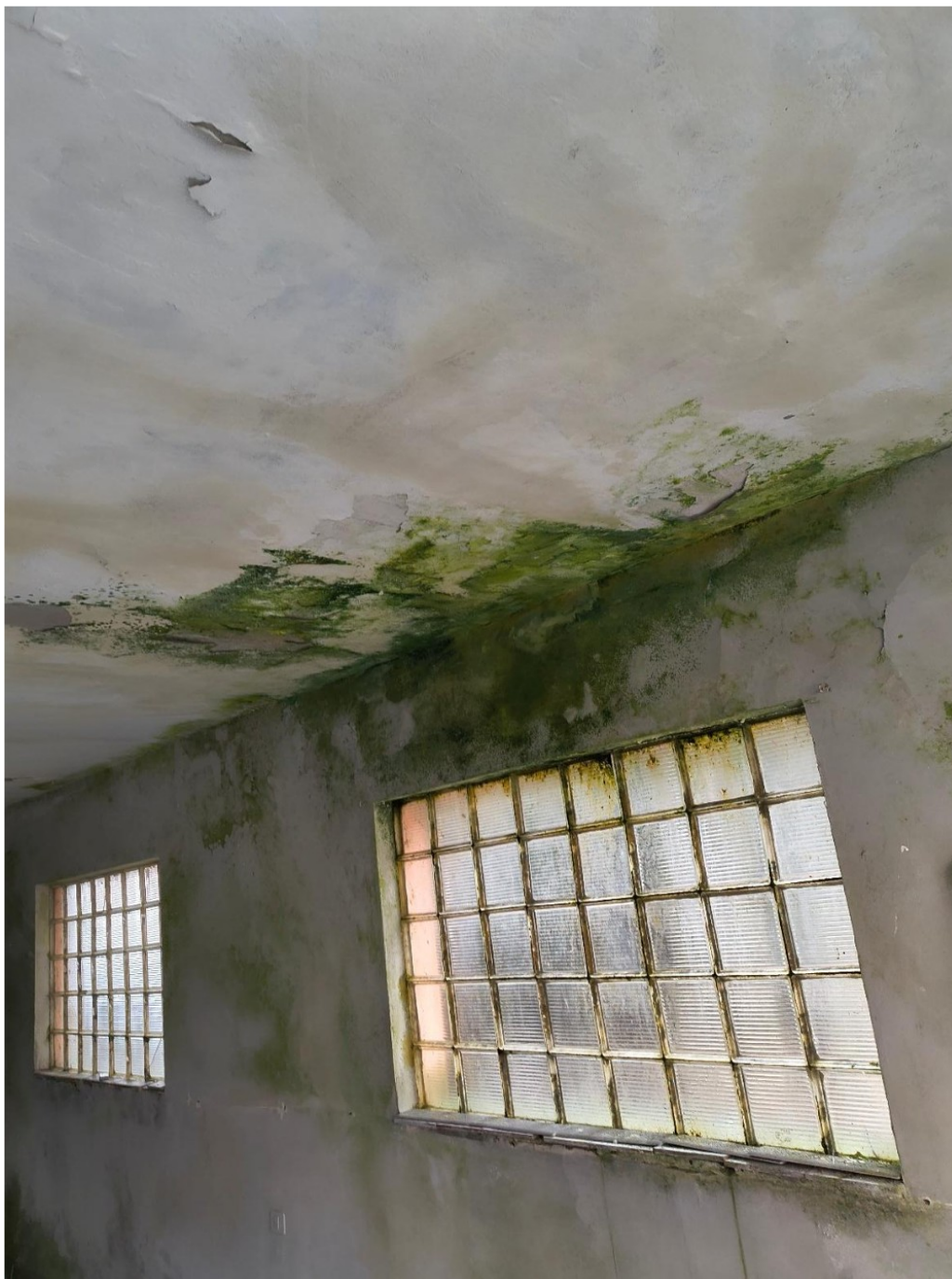
VISTA DELLE DUE APERTURE CHE AFFACCIANO SUL LATO OVEST, CON DETTAGLIO DELLE INFILTRAZIONI
