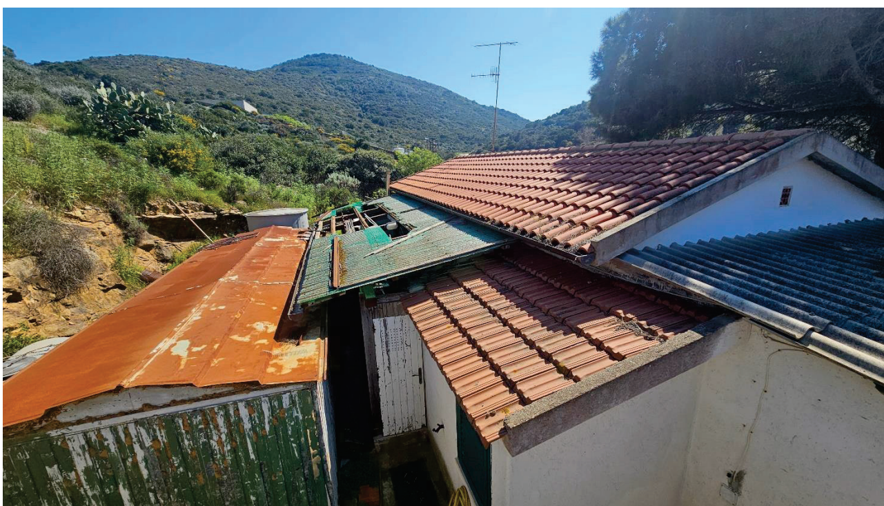
Esterno fabbricato con vista manufatti abusivi
