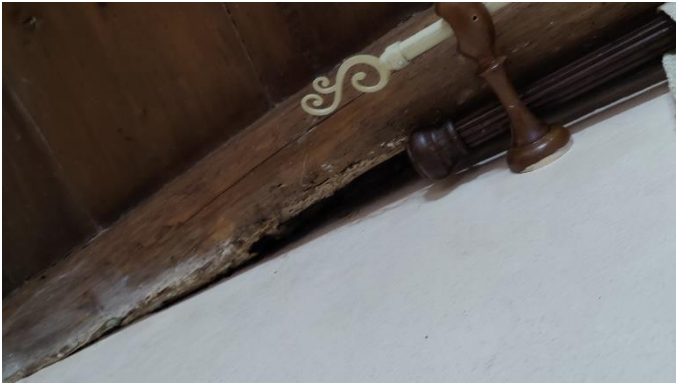
TRAVE SOLAIO SALOTTO (marcescenza da infiltrazione)
