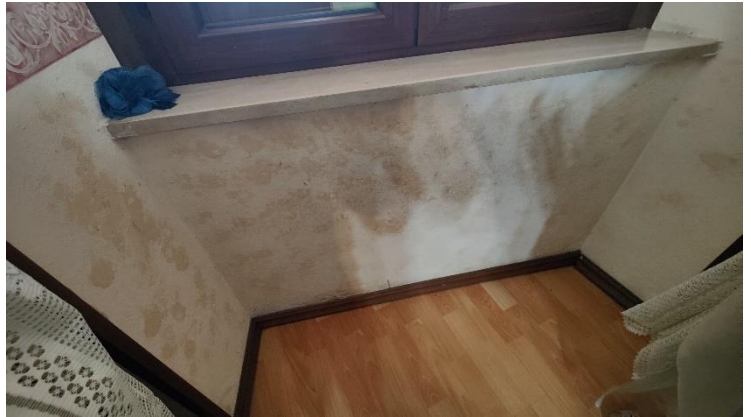
PARETE MURATURA SALOTTO SOTTO FINESTRA VS. STRADA (Degrado da umidità con sviluppo di muffa)
