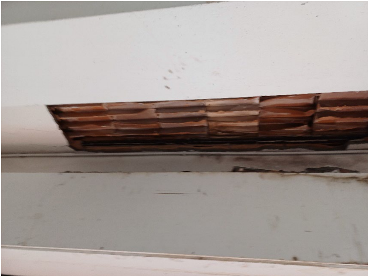
DISTACCO PIGNATTE GARAGE
