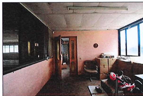
37 foto lotto 4 edificio sub 4 direzione soppalco
