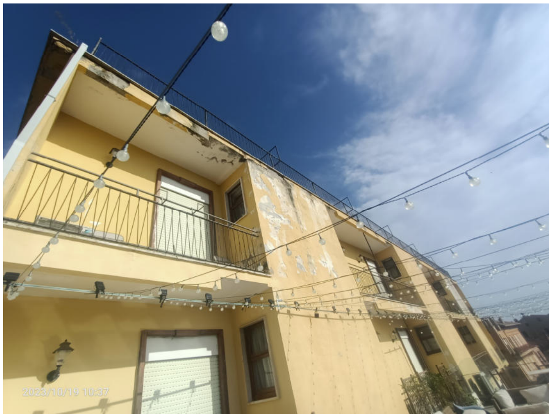
Danni da infiltrazioni da acque meteoriche
