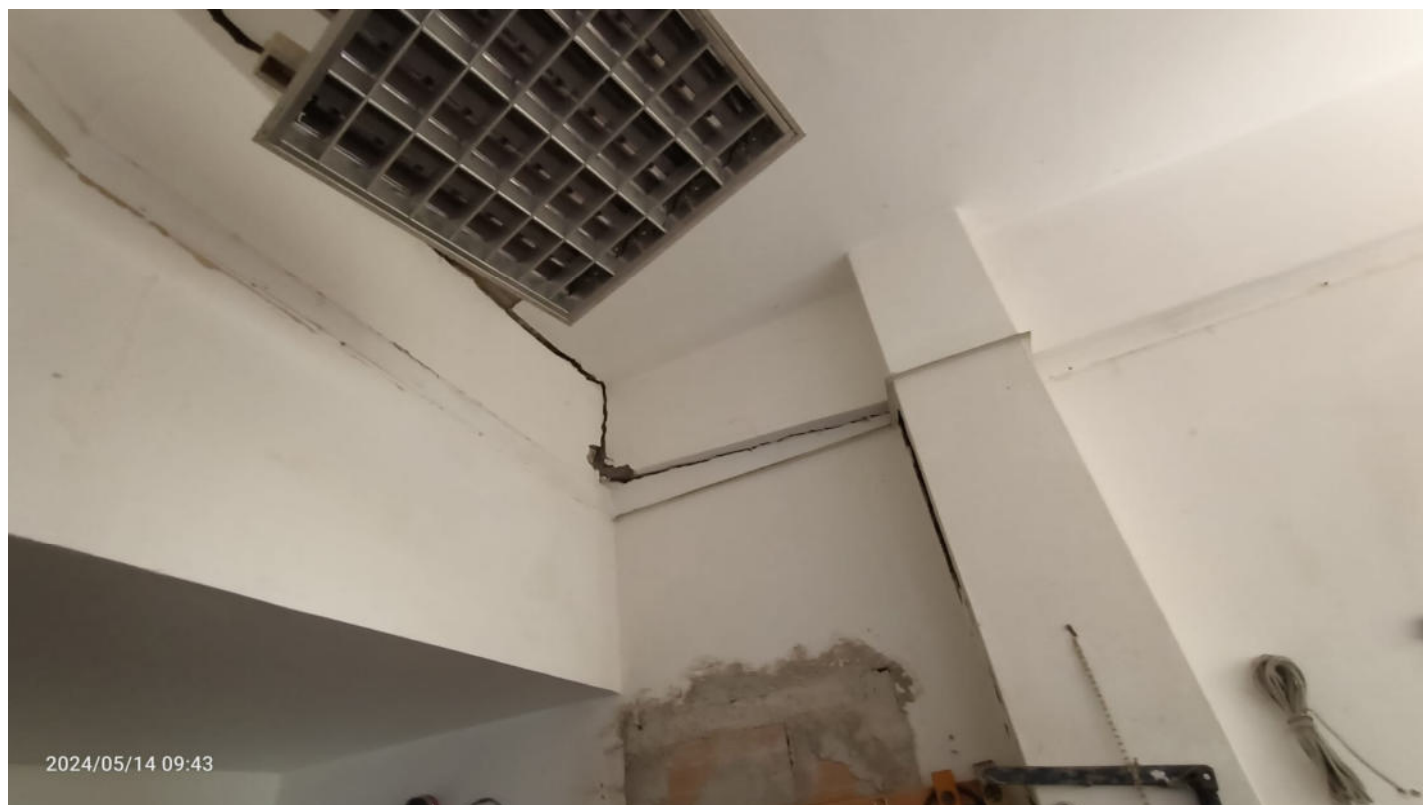
Crepe da fenomeni di subsidenza al piano S3
