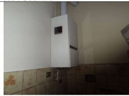
Sub 15, finiture e stato conservativo
