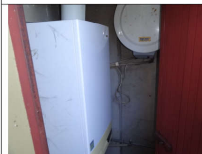
Sub 14, finiture e stato conservativo
