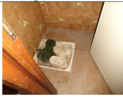
Sub 15, finiture e stato conservativo
