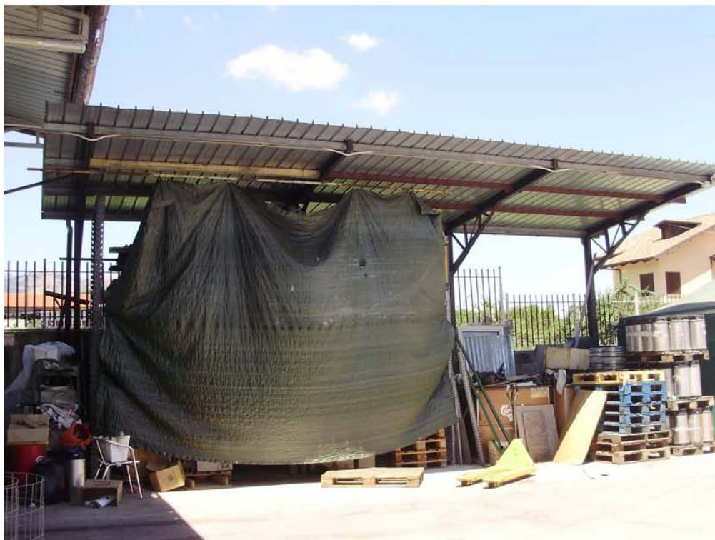
Foto n. 11 – tettoia abusiva costruita sulla corte del fabbricato
