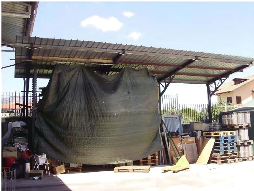
Foto n. 11 – tettoia abusiva costruita sulla corte del fabbricato
