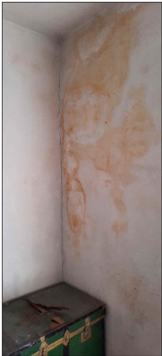
Infiltrazioni piovane su pareti esterne
