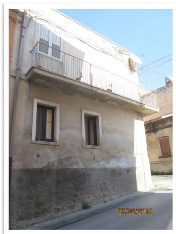
Foto 3 prospetto Via Donizetti, si rileva degrado alla facciata dovuto a umidità di risalita
