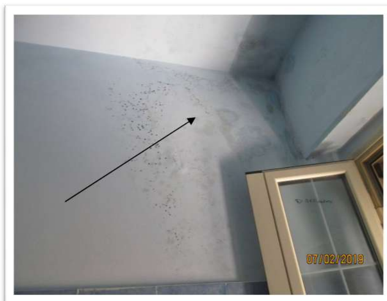
Foto 9 infiltrazioni da copertura
