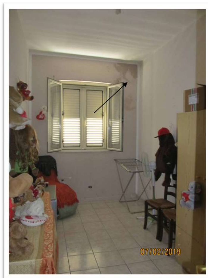
Foto 8 piano primo camera da letto, si evidenziano infiltrazioni dalla copertura
