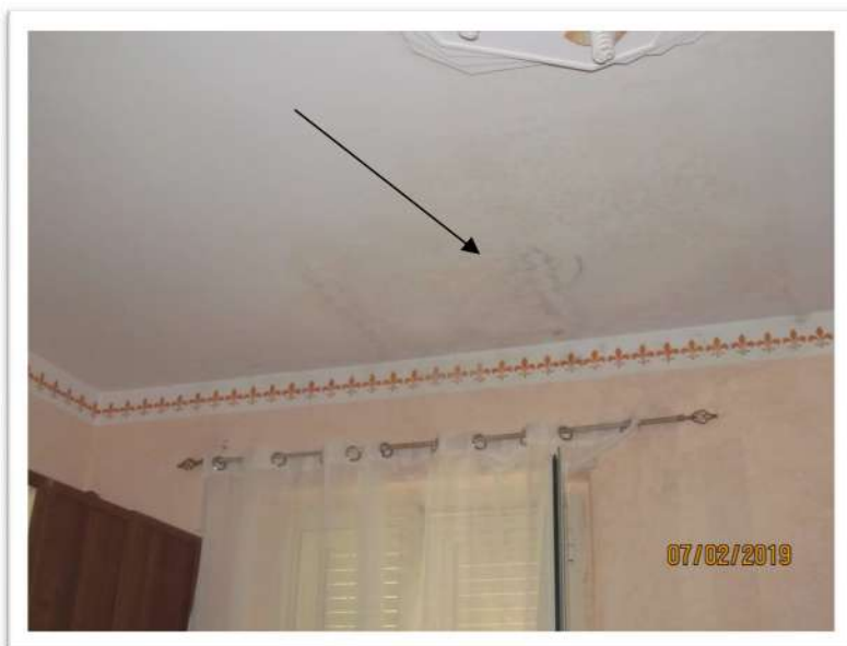
Foto 11 infiltrazione da copertura
