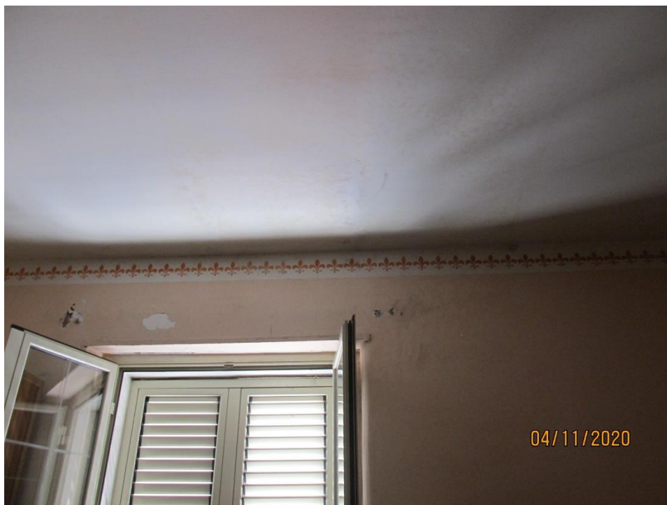
Figura 6 INFILTRAZIONI PROVENIENTI DALLA COPERTURA
