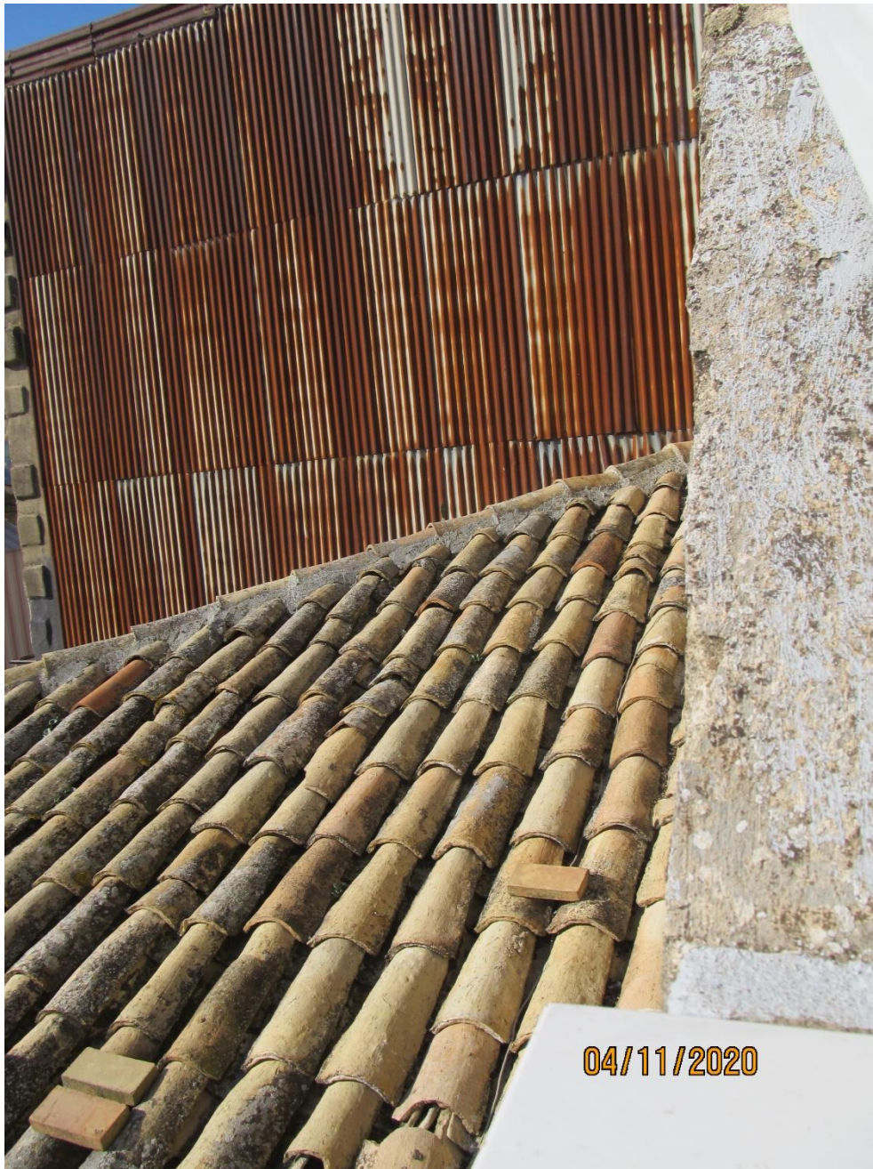
Figura 2DANNI ALLA COPERTURA DELL'IMMOBILE IN OGGETTO
