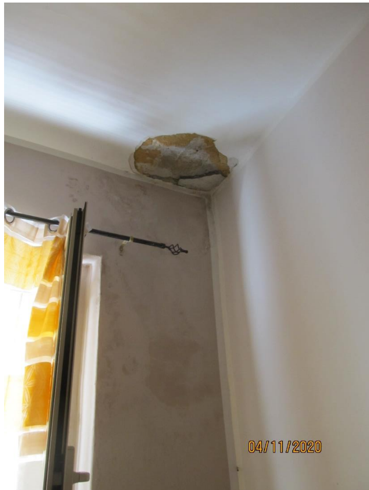
Figura 4 INFILTRAZIONI PROVENIENTI DALLA COPERTURA
