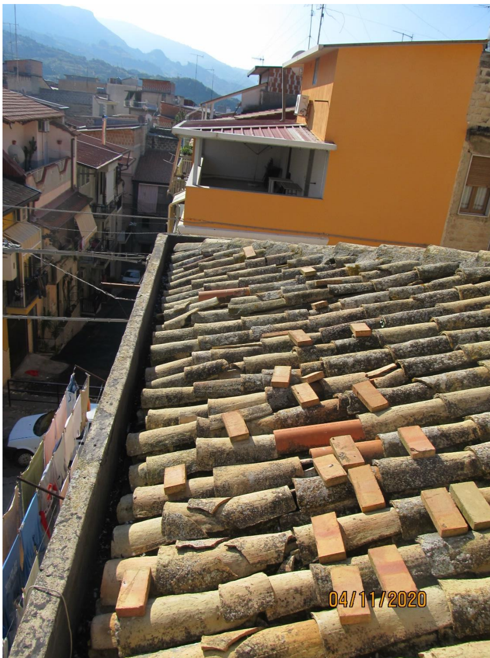
Figura 1 DANNI RILEVATI ALLA COPERTURA DELL'IMMOBILE
