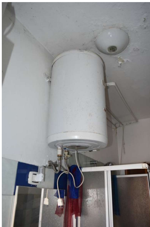
Foto 27: Servizio igienico, particolare boiler elettrico
