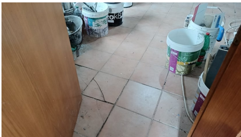
PT Fessurazione e rigonfiamento pavimentazione
