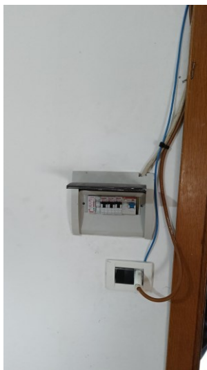
Quadro elettrico locale dx corridoio ingresso
