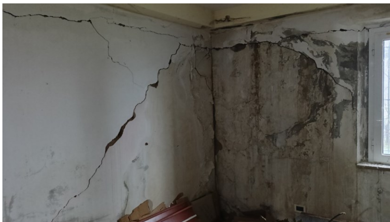
PT Fessurazione angolo parete lato sx/retro
