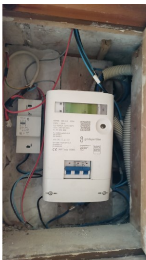
Contatore luce posto nel corridoio d'ingresso
