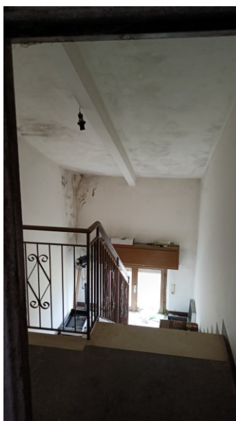
Vano scala P1/P2 con evidenza infiltrazioni
