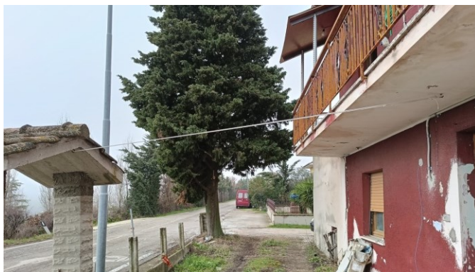
Ancoraggio al balcone della pensilina pericolante
