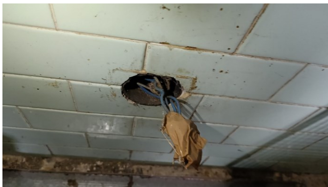
Conduttori elettrici locale piano terra lato dx/retro
