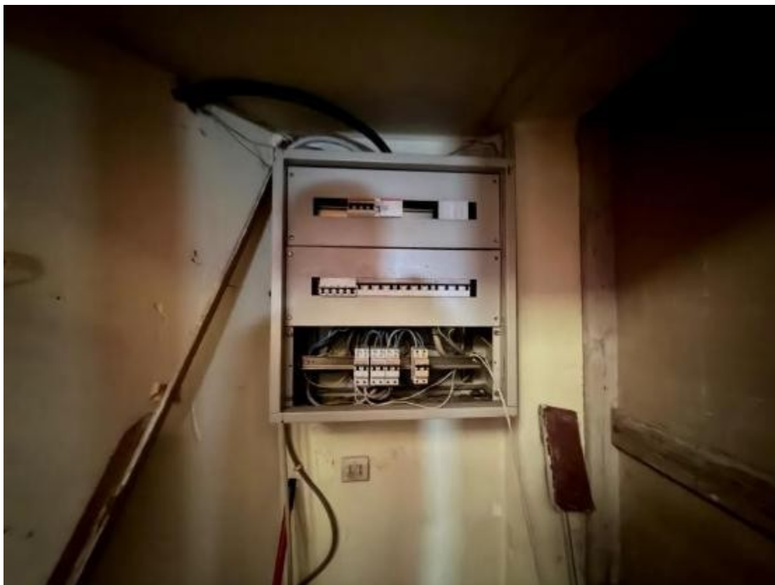
Particolare Quadro Elettrico sottoscala – in disuso
