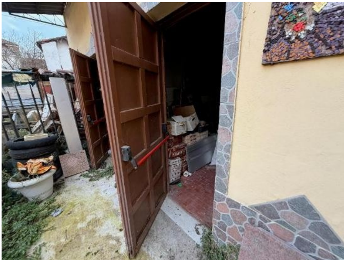
Ingresso locale accumulo ACS
