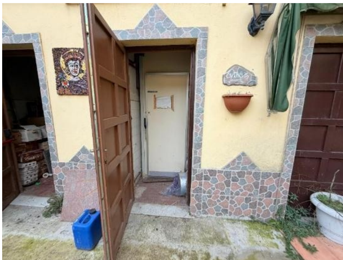
Accesso al Locale ove è installata la cella frigo
