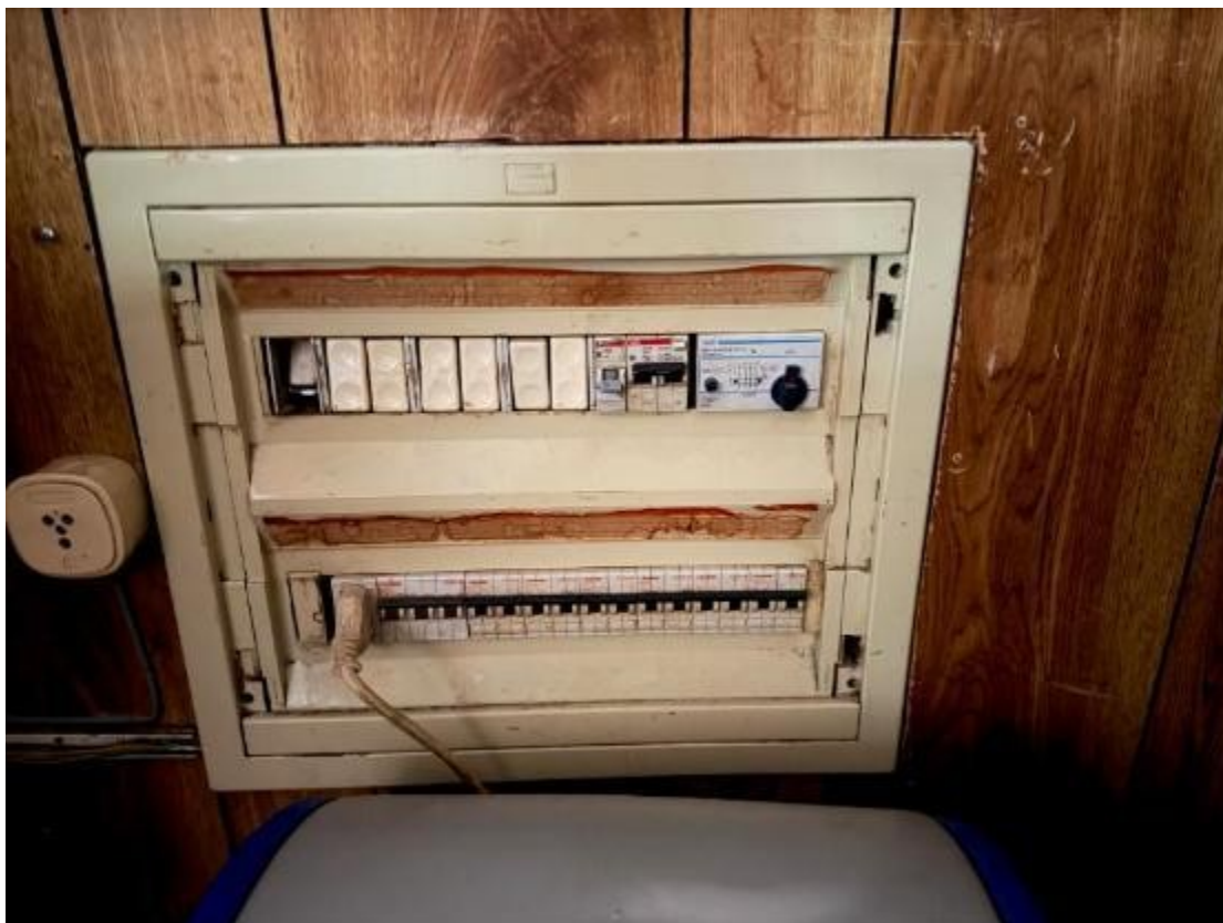
Hall Ingresso + Bar (altra vista) – particolare quadro elettrico
