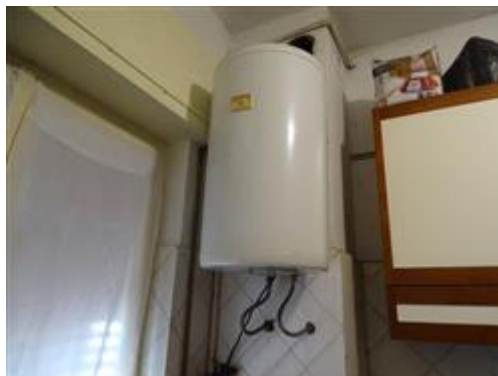
Boiler acqua calda elettrico
