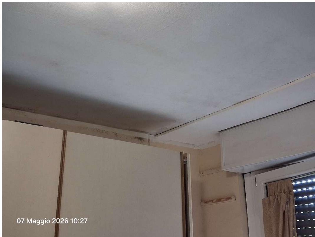
FOTO 9 - Vista interna camera 2 – condensa superficiale
