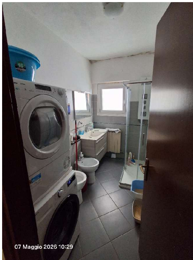
FOTO 7 - Vista interna bagno – condensa superficiale
