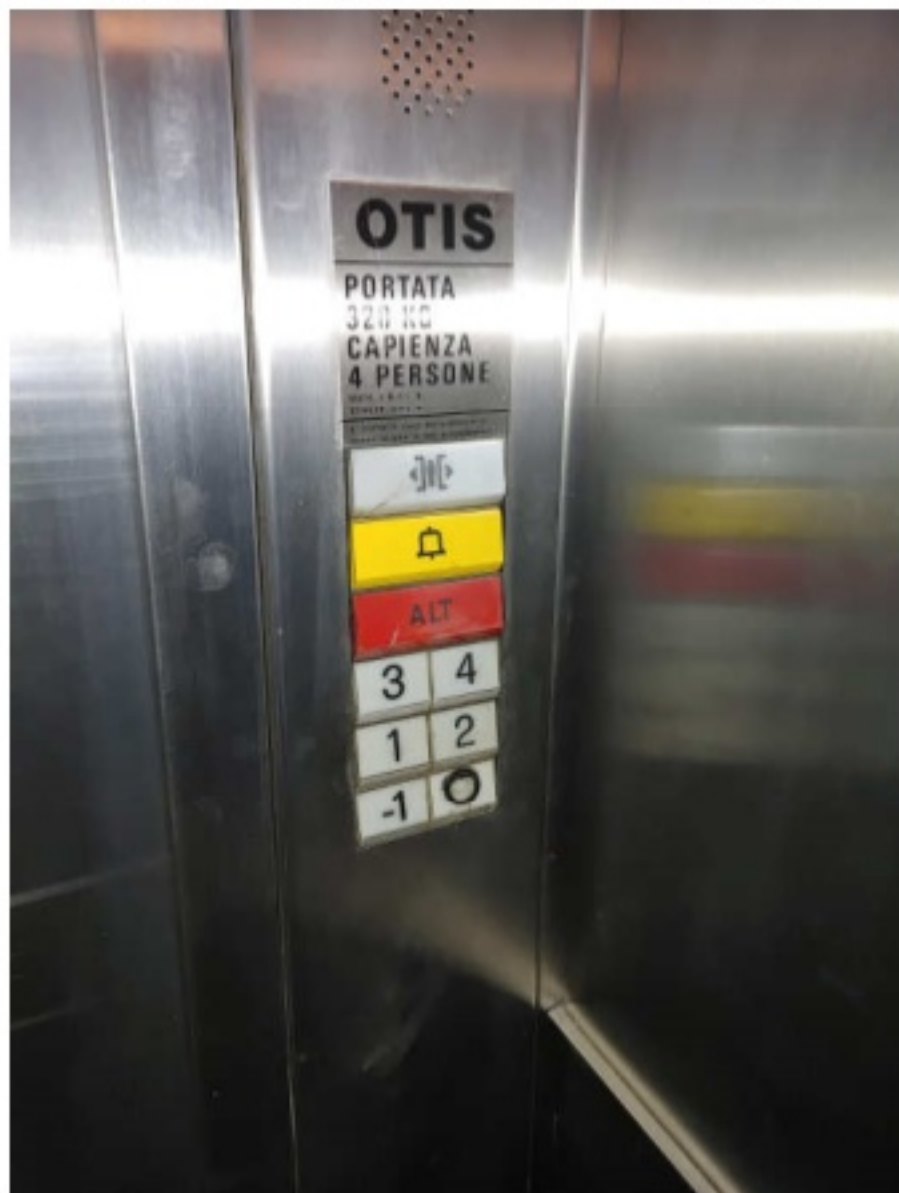
Foto 10 – Vista interno cabina ascensore
