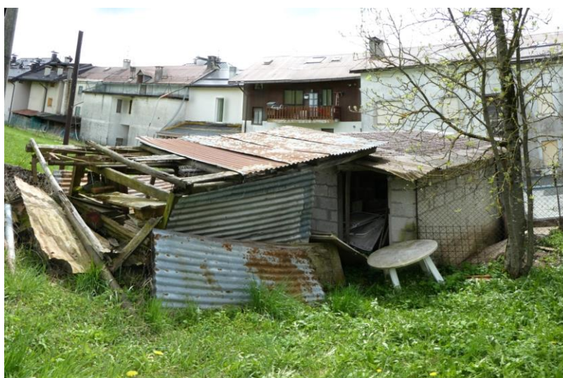
9. – Manufatto sul mapp. 1430 – lato Nord/Est con tettoia in lamiera da rimuovere
