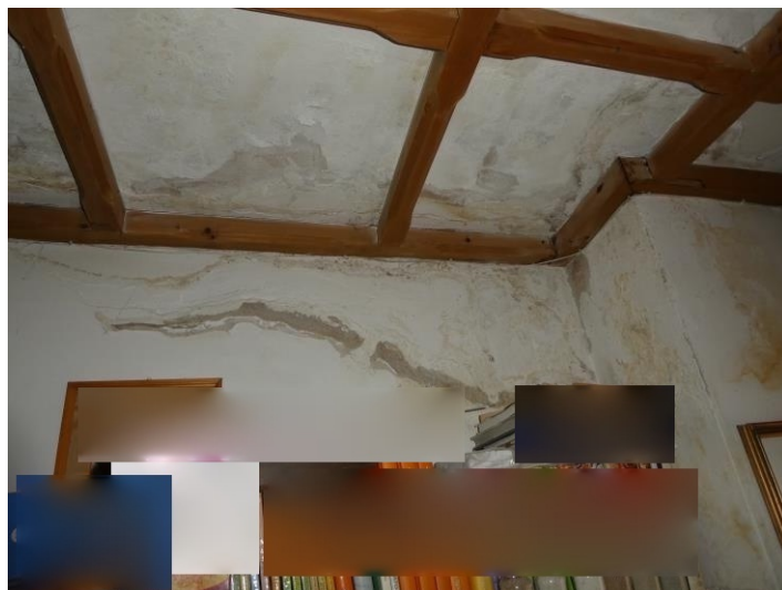
18. – Segni di infiltrazioni nel Locale Studio/Amministrazione
