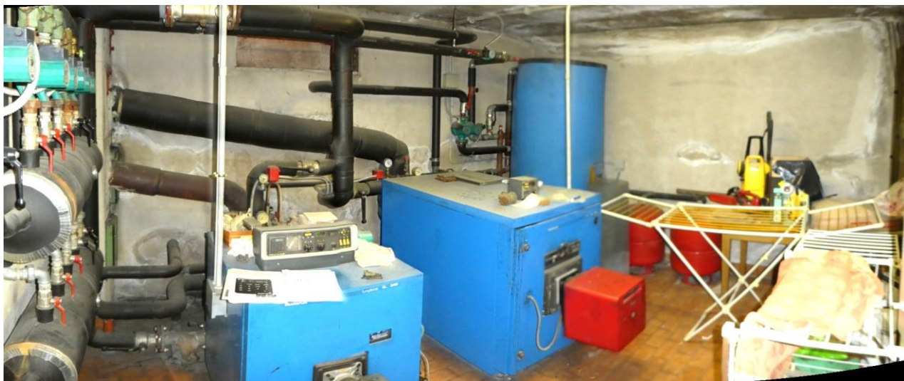
41. – locale Centrale Termica – piano Interrato
