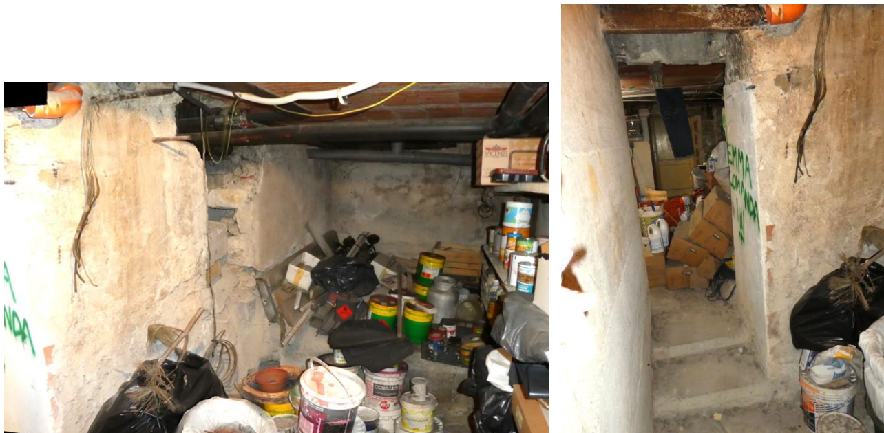
46. – locali Deposito con pareti da ripristinare – piano Interrato
