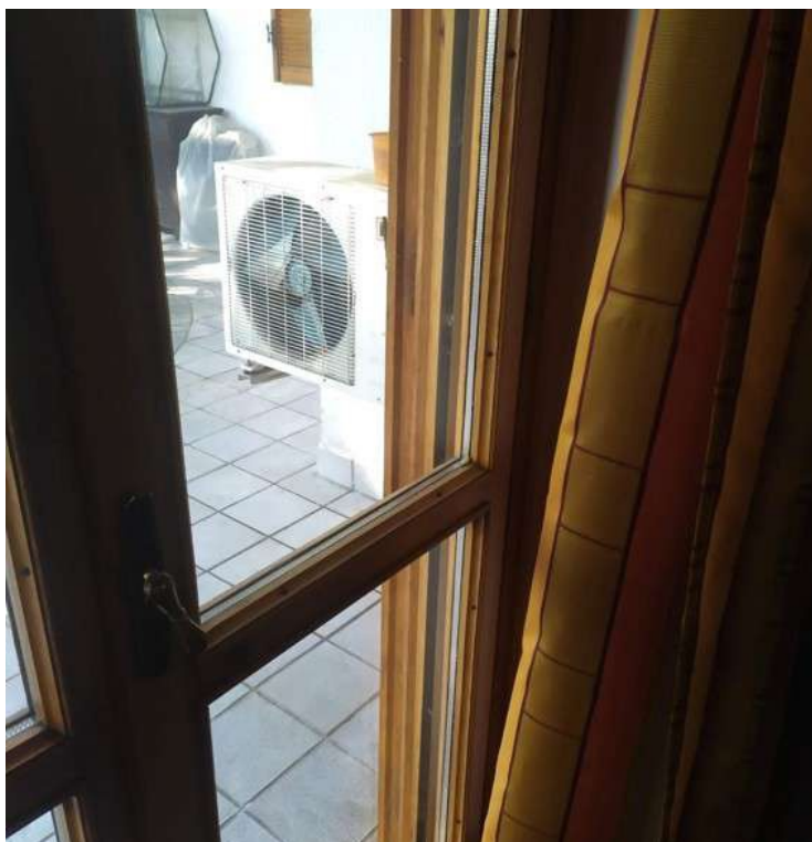
Fotografia C.7 - piano terreno - vista sull'unità esterna monosplit posta nella veranda lato cortile che serve il locale tinello
