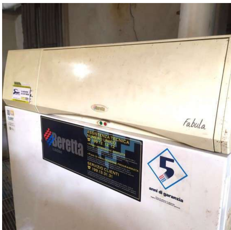
Fotografia C.11 - caldaia a basamento autonoma posta nel locale C.T.
