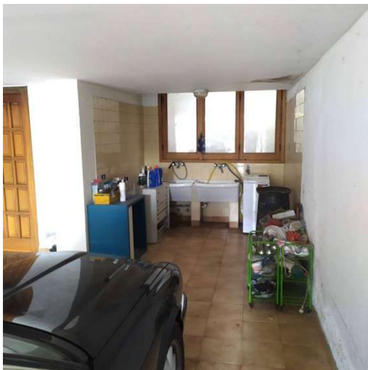
Fotografia C.5 - piano seminterrato - vista su locale lavanderia dov'è evidente l'assenza della porta all'intercapedine e quella di accesso all'adiacente locale attrezzi chiusa in seguito ai lavori di recupero strutturale post incendio
