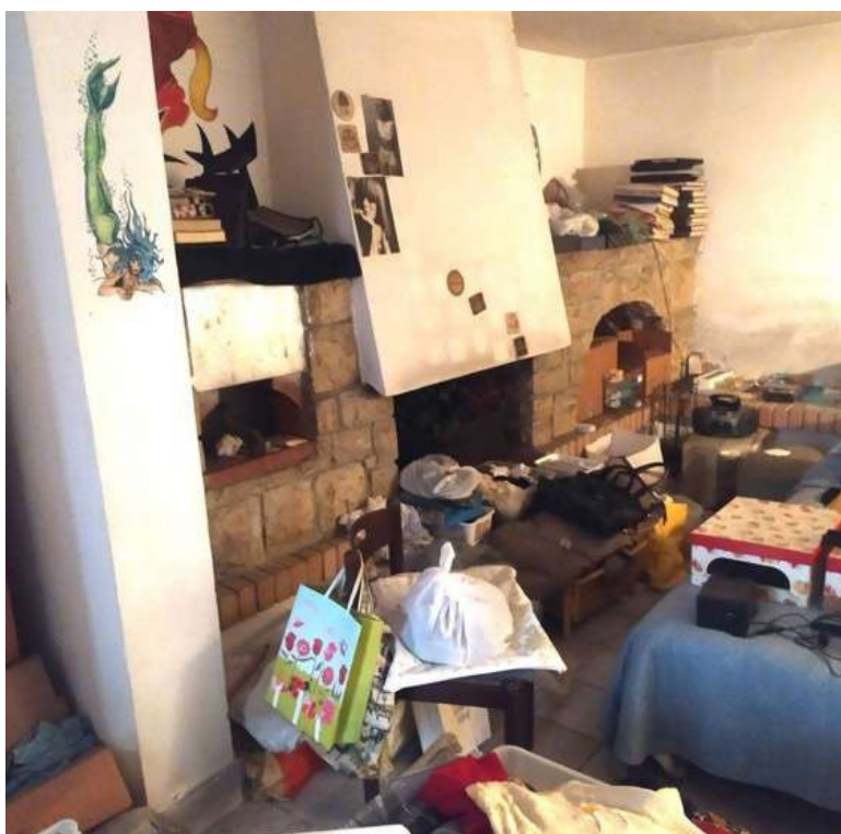
Fotografia C.2 - piano seminterrato - vista sul camino e forni posti nella zona condonata del piano cantinato ed erroneamente non rappresentati nella scheda catastale e nella DIA 117/08
