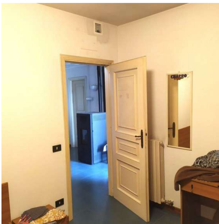
Fotografia C.16 - piano primo - dalla camera lato ovest con vista sulla caldaia a pellet posta nel corridoio ... sopra la porta si nota la bocchetta della canalizzazione
