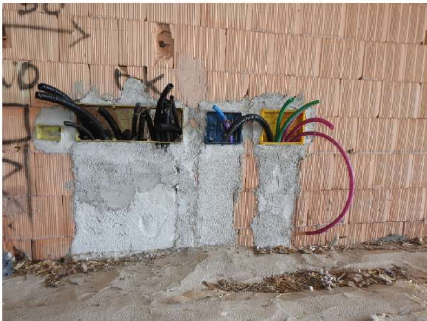
Foto 3 - Dettaglio delle predisposizioni dell'impianto elettrico e degli impianti speciali, con cassette da incasso di diversa dimensione e numerose tubazioni corrugate in arrivo e in partenza, verosimilmente destinate alla distribuzione delle linee di alimentazione, prese, illuminazione e collegamenti tecnologici della sala lettura.
