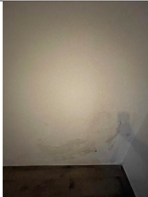
Umidità piano scantinato sub 2
