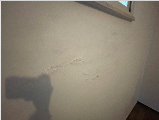
Umidità piano scantinato sub 2
