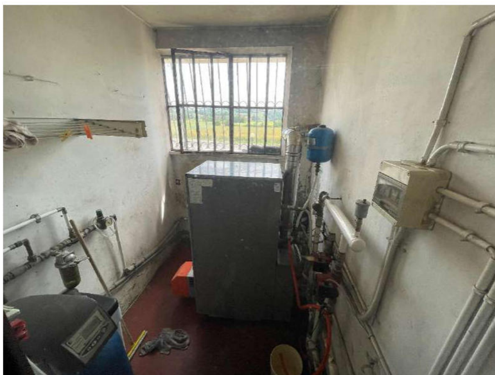
Piano Terra - Ripostiglio 2 (con CT Gasolio) - Sub.1
