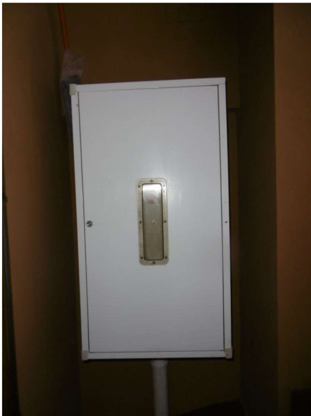
Esterno Alloggio – Terrazza - Caldaia
