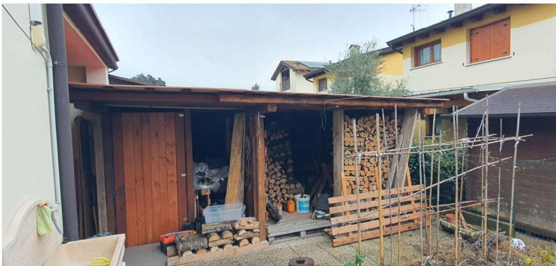
Esterno – P.T. – Tettoia da rimuovere
