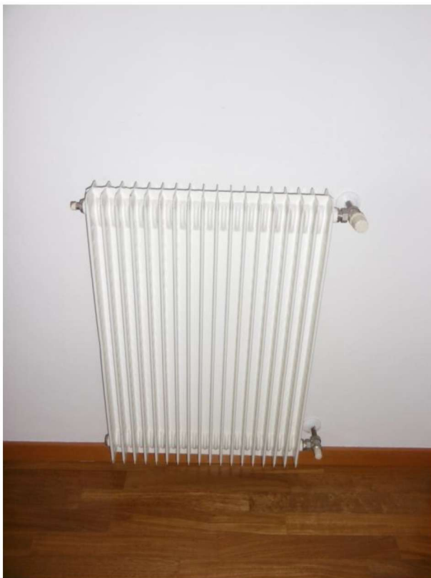
Interno Alloggio - Radiatore
