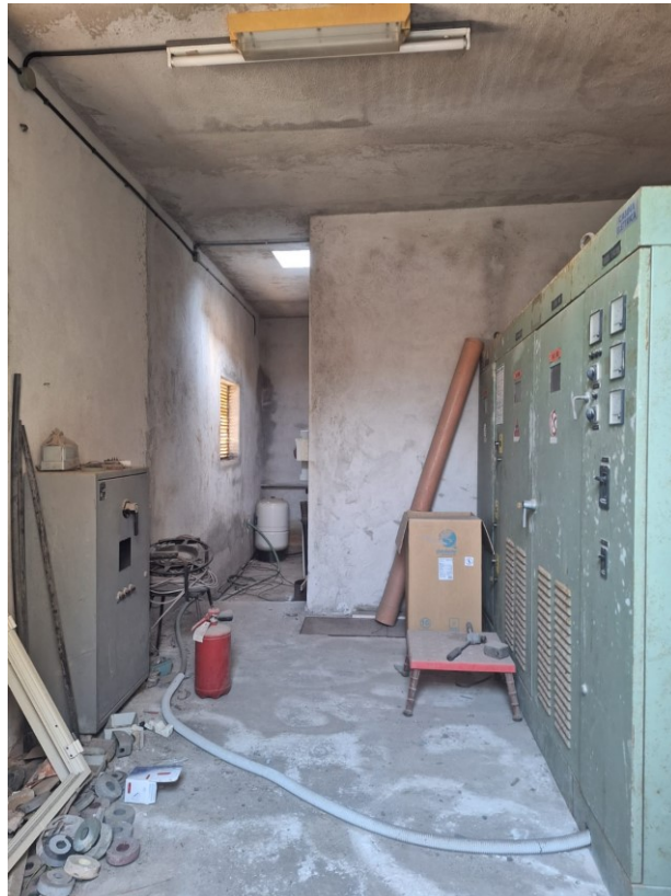
Foto 32 – Locale macchine , volume non autorizzato adiacente alla cabina dell' Enel
