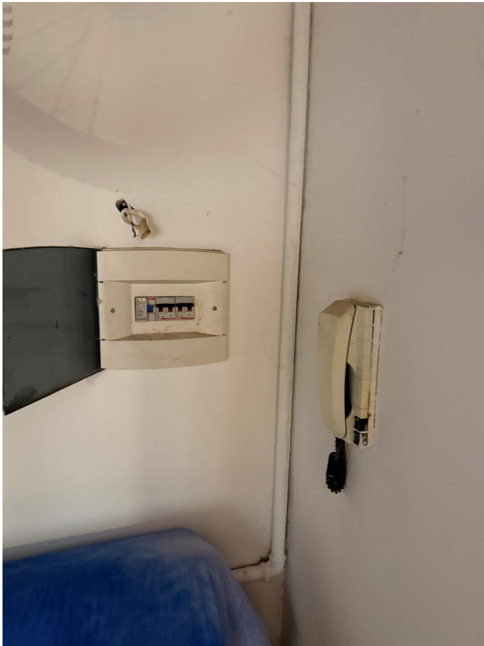
SOGGIORNO 1 – PARTICOLARE QUADRO ELETTRICO E CITOFONO (FOTO 3)
