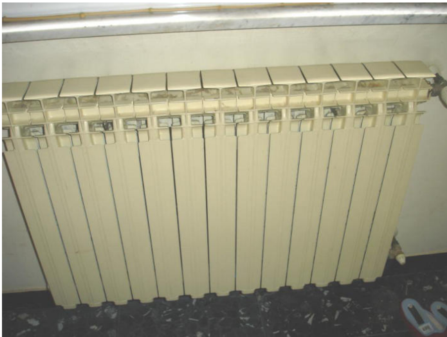
Particolare calorifero camera da letto matrimoniale
