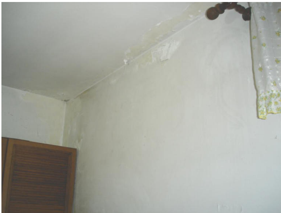
Vista della parete/soffitto della cucina: macchie di umidità e/o muffe
