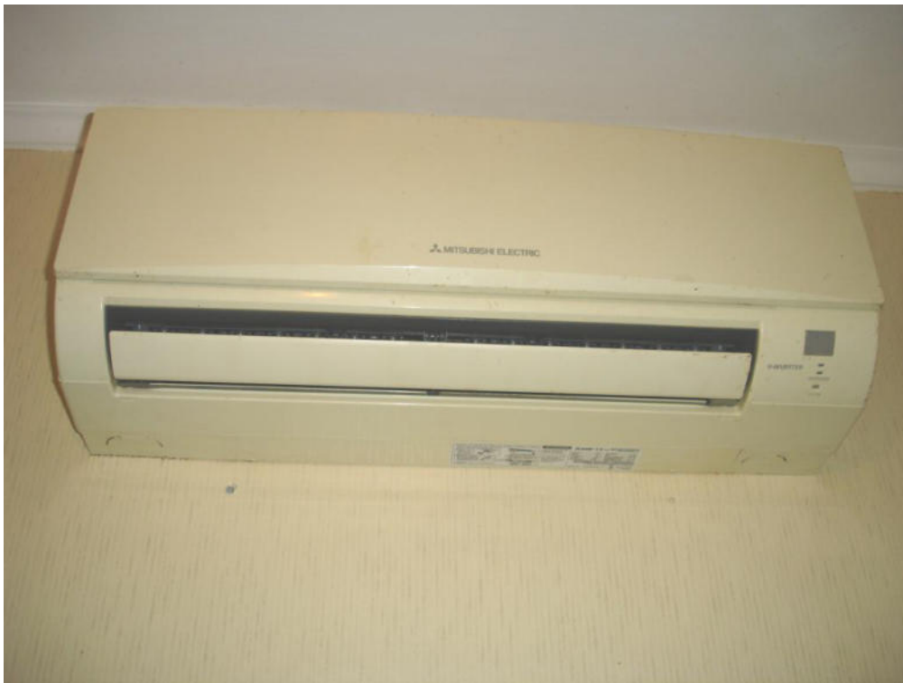
Vista unità interna del condizionatore
