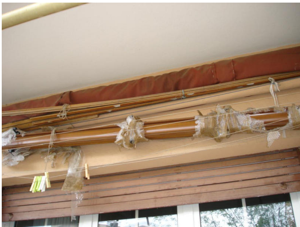
Particolare rottura della tenda da sole del soggiorno
