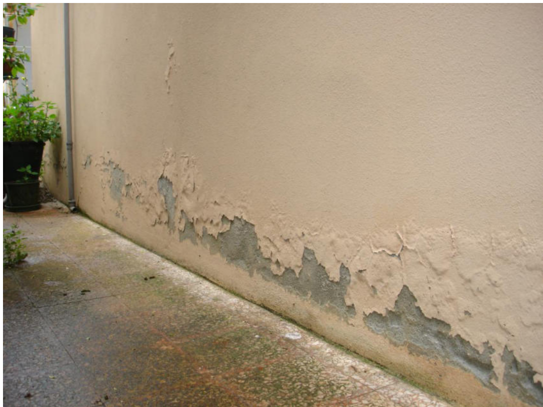
Particolare parete ovest: intonaco scrostato e sfogliato
