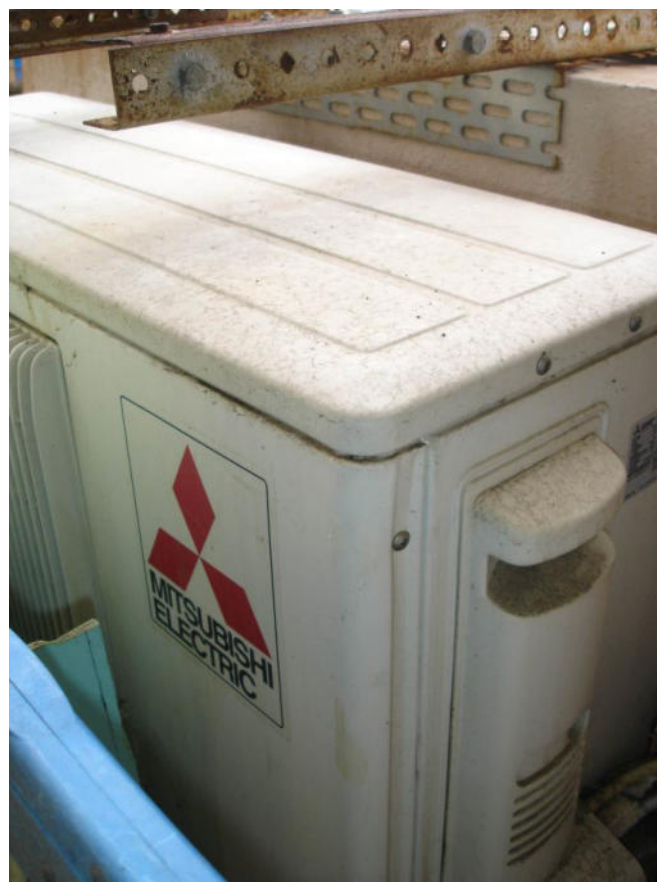
Vista unità esterna del condizionatore
