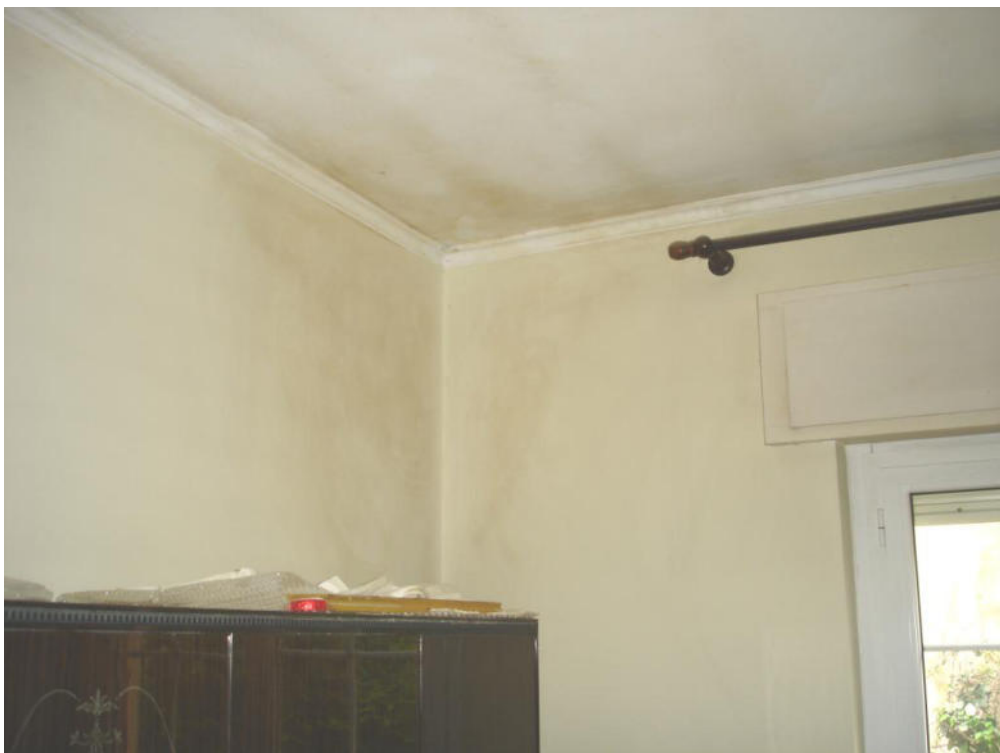
Particolare macchie angolo parete / soffitto (camera da letto matrimoniale)
