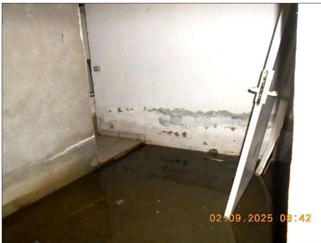
Figura 43 – vista interna delle infiltrazioni d’acqua nei locali al piano seminterrato
