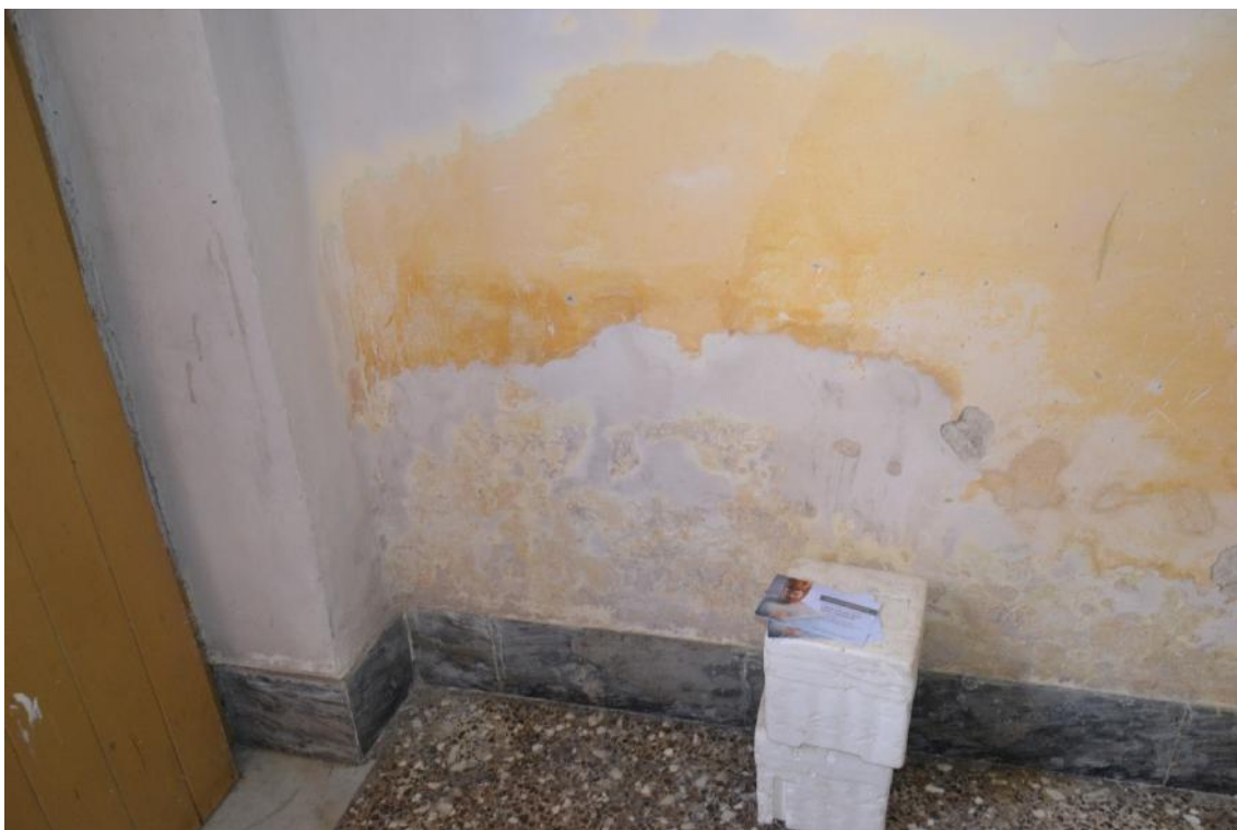
Foto 14: vista precarie condizioni delle murature
