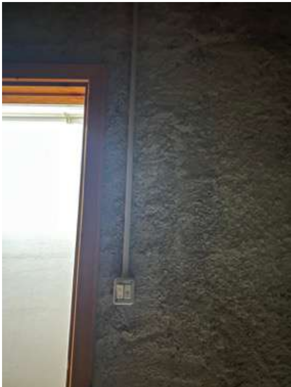
Figura 46 impianto elettrico non funzionante
