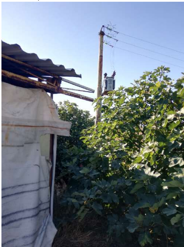
Foto 31) Palo Enel con trasformatore per 18 KW.
