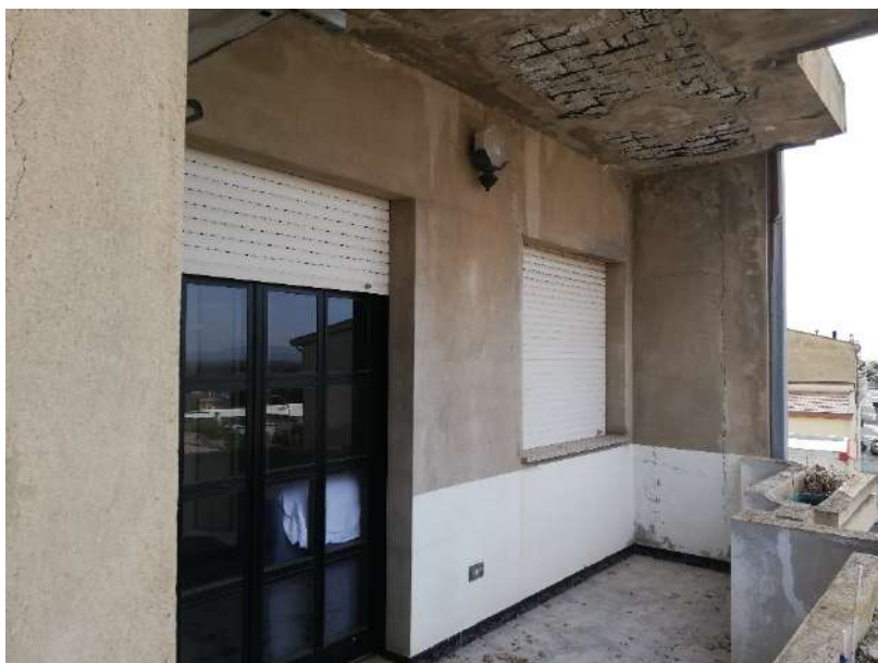
Foto 18) Balcone lato strada (si vada stato di degrado del solaio di copertura).
