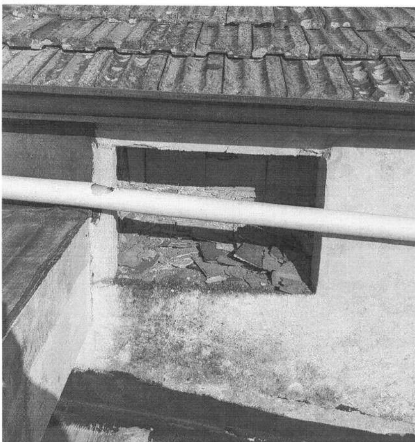
Sopralluogo del 28/06/2023. Unico accesso agevole al locale deposito di sottotetto occluso con laterizi e malta cementizia ed ostacolato da tubo in PVC utilizzato per il deflusso delle acque meteoriche.
