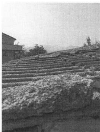
Foto 31: Il manto di copertura necessita di revisione di tenuta e messa in sicurezza.
