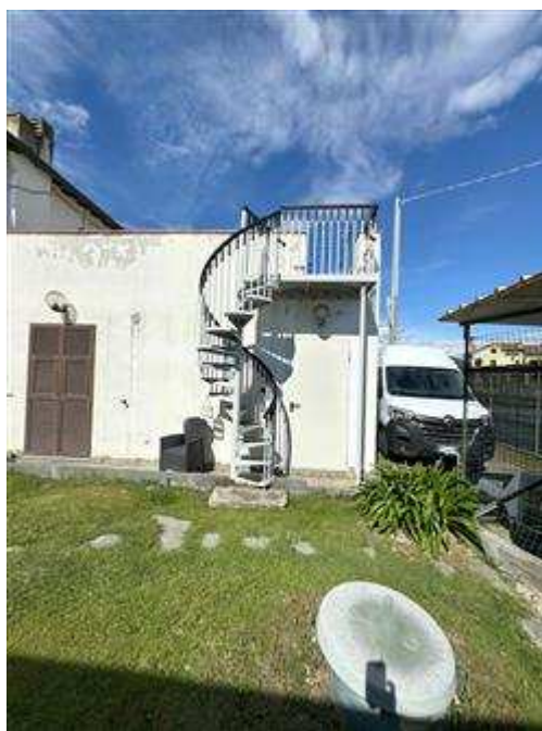
Scala esterna non autorizzata
