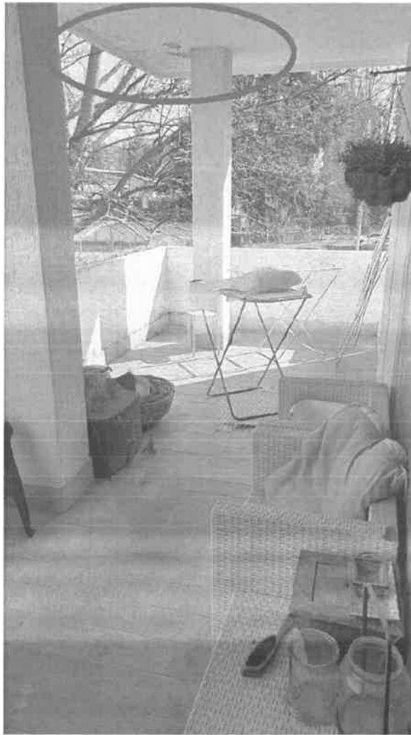
Zona interessata dal distacco di calcinacci
