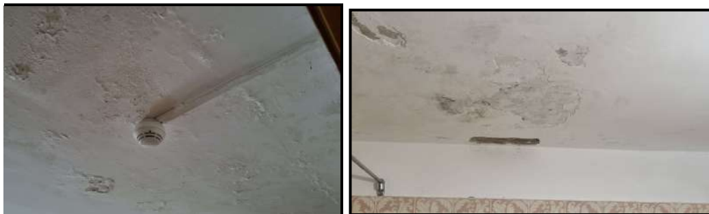
PIANO TERZO – ALCUNI PROBLEMI AGLI INTONACI STANZA E BAGNO
